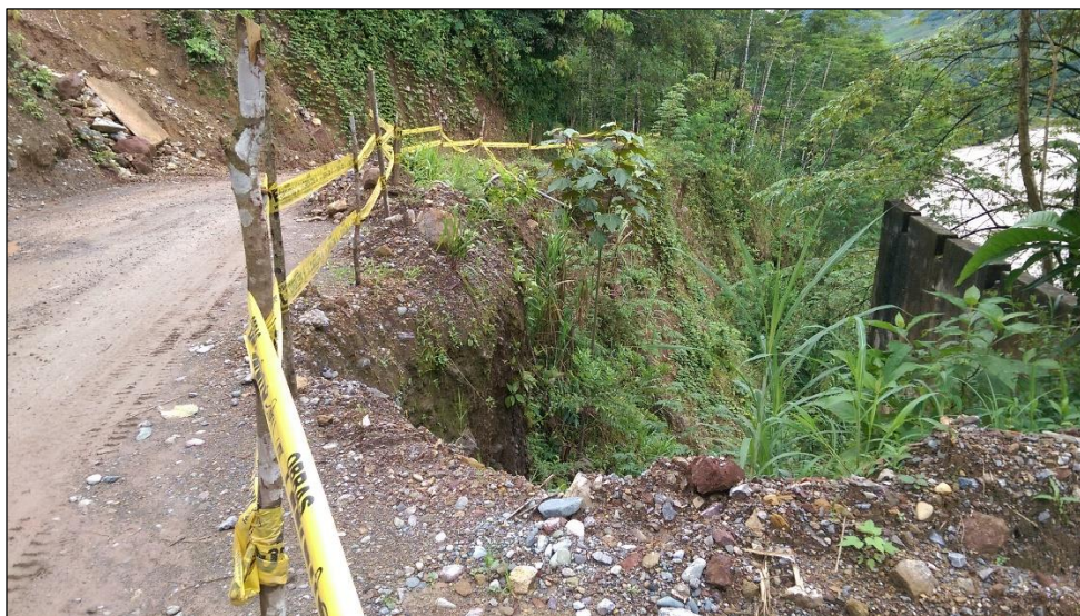
Figura 2: Pérdida de plataforma en el Sector la Esperanza km 0+807 distrito de Pozuzo
