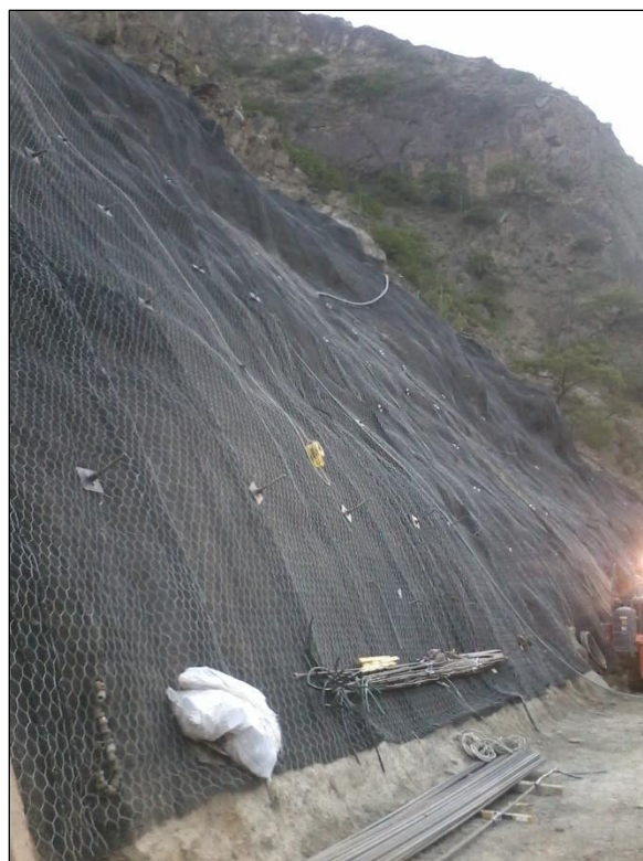
Figura 47: Talud estabilizado mediante anclajes, Proyecto: C.H. Cerro del Águila – GyM y Astaldi (Fuente: Propio, 2015)
