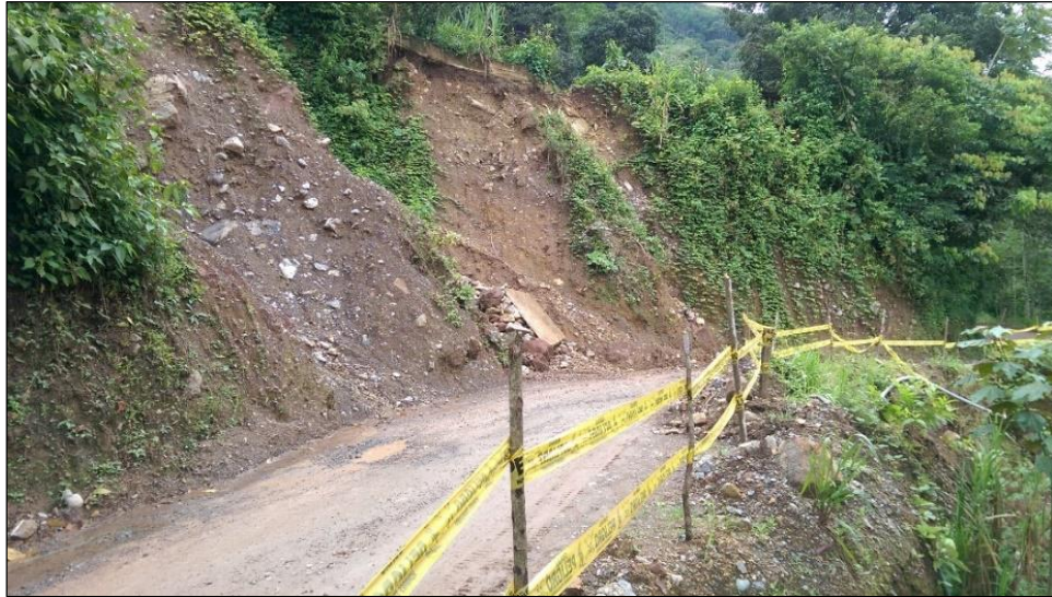
Figura 1: Inestabilidad de talud en la parte superior del sector La Esperanza km 0+807 del distrito de Pozuzo.
