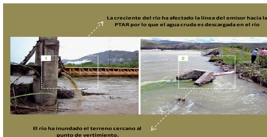
Figura N°46. PTAR con infraestructura afectada
