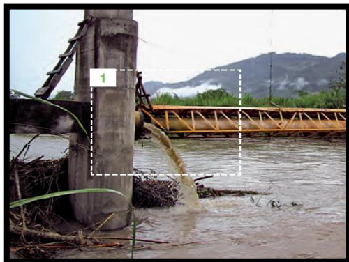
Fotografía 1. Estructura erosionada selva central.
