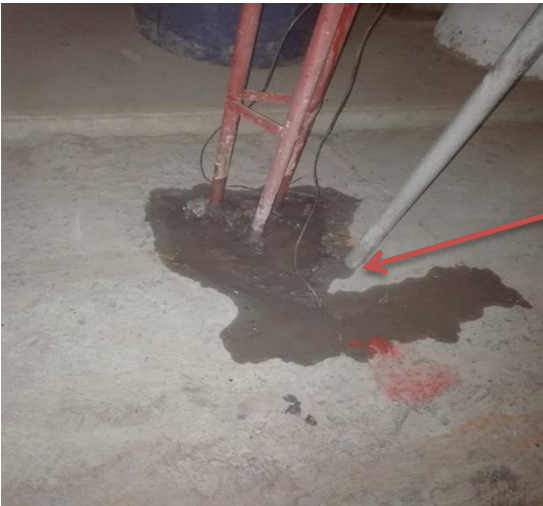
Ilustración 14: Charco de agua filtrada de uno de los agujeros del techo metálico
