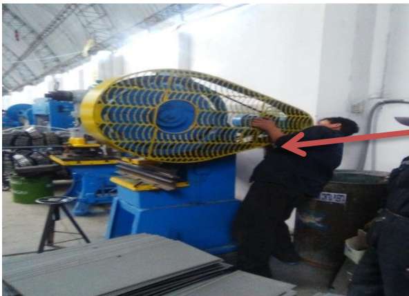
Ilustración 5: Instalación de guardas de seguridad
