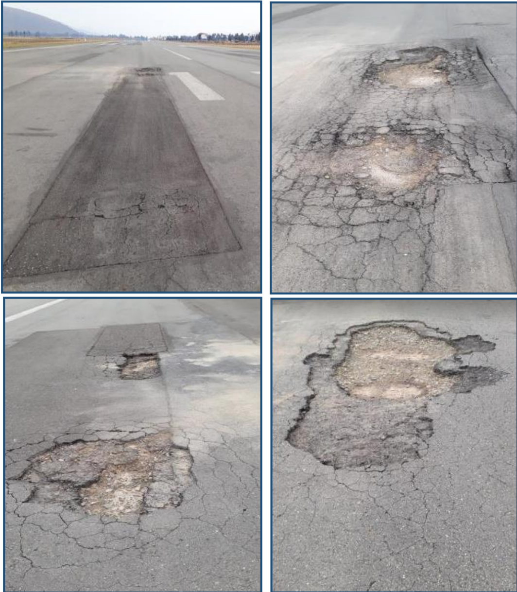
Fotografía 4. Baches en la pista de aterrizaje del Aeropuerto Francisco Carlé de Jauja
