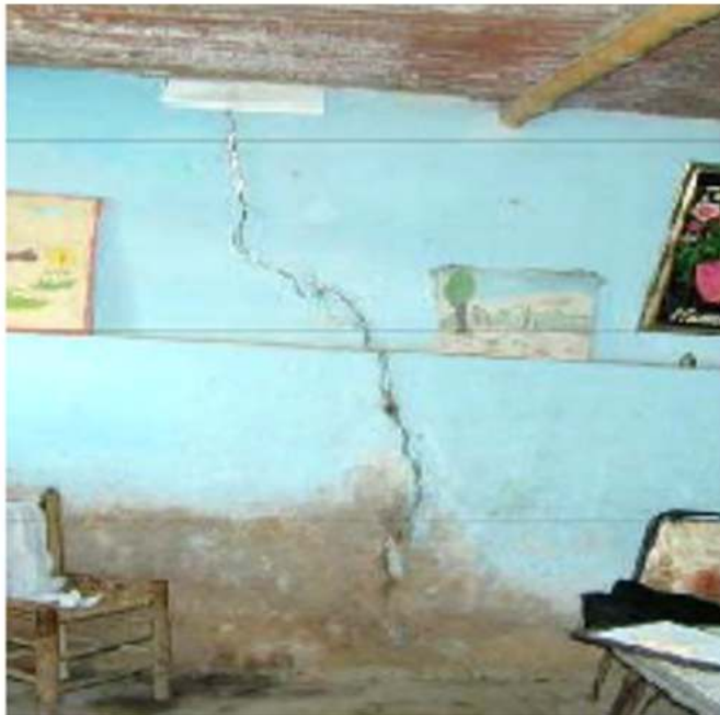
Figura 14 Grieta en muro por asentamiento diferencial. Fuente: pucp.edu.pe/albañilería .
