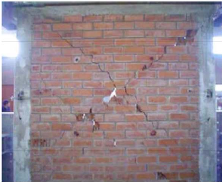
Figura 11 Muro con grietas en las dos diagonales. Fuente: pucp.edu.pe/albañilería .
