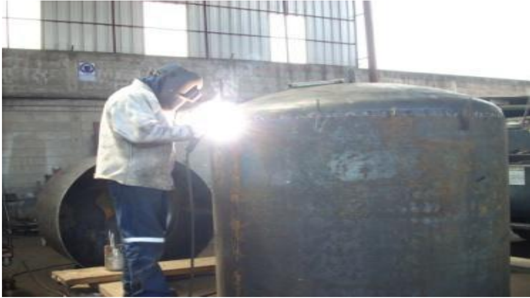
Fotografía: C-7 Soldadura biselada unión tapa – tanque.
