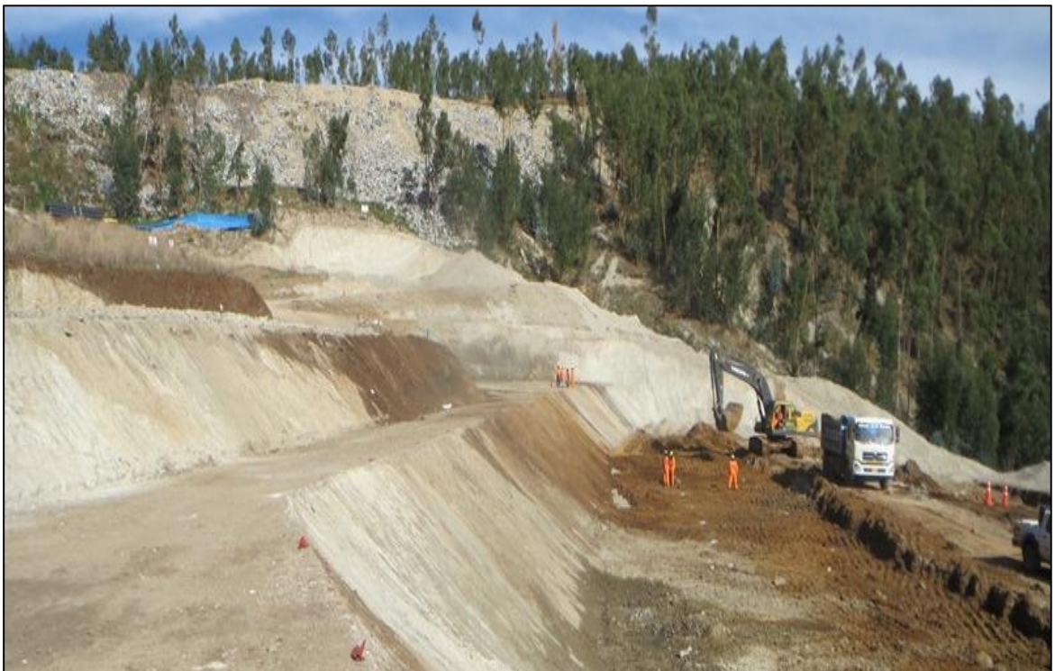
Figura 41, se observa la disminución de humedad en las 04 terrazas
