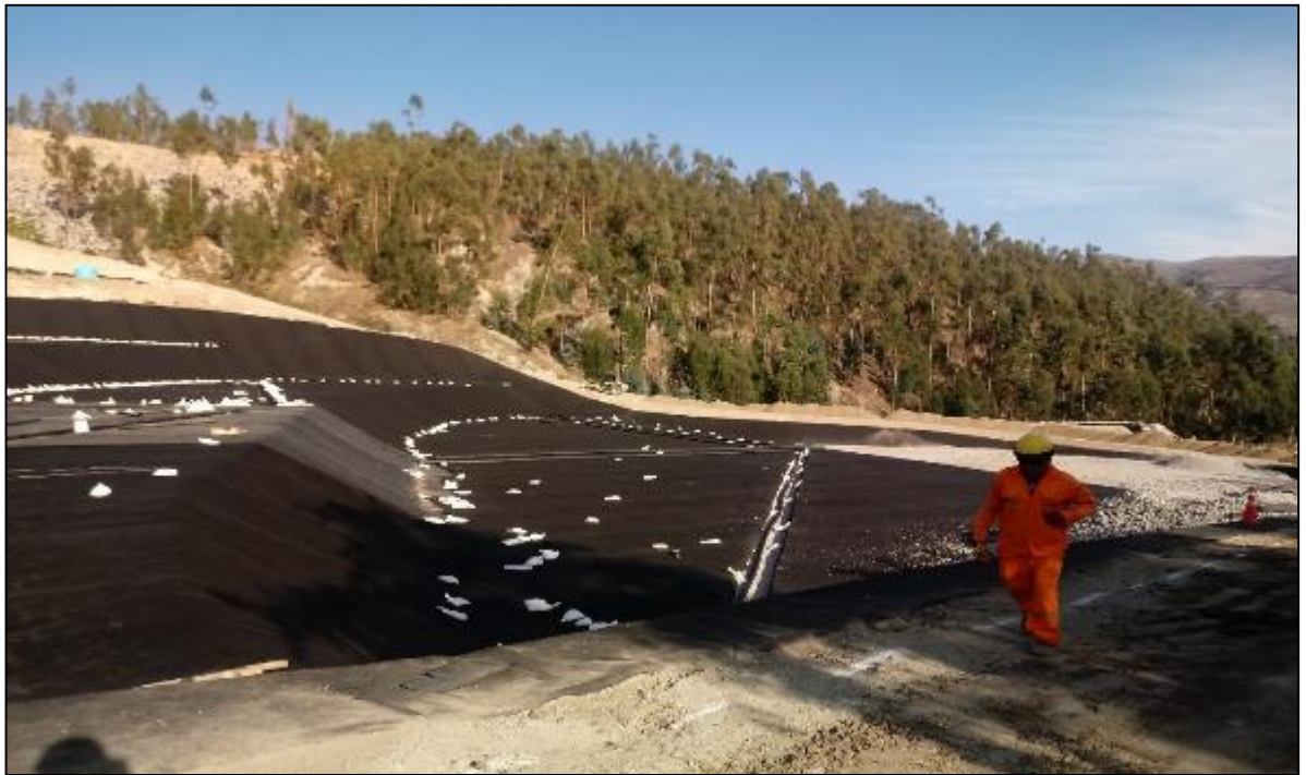
Figura 46, se observa la instalación completa de geomembranas y geotextiles sobre las plataformas completamente secas.
