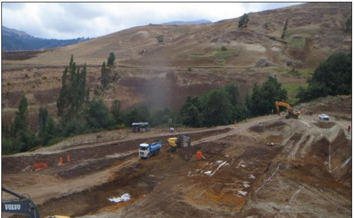
Figura 35, vista del suelo saturado de las 04 terrazas para la construcción del relleno sanitario
