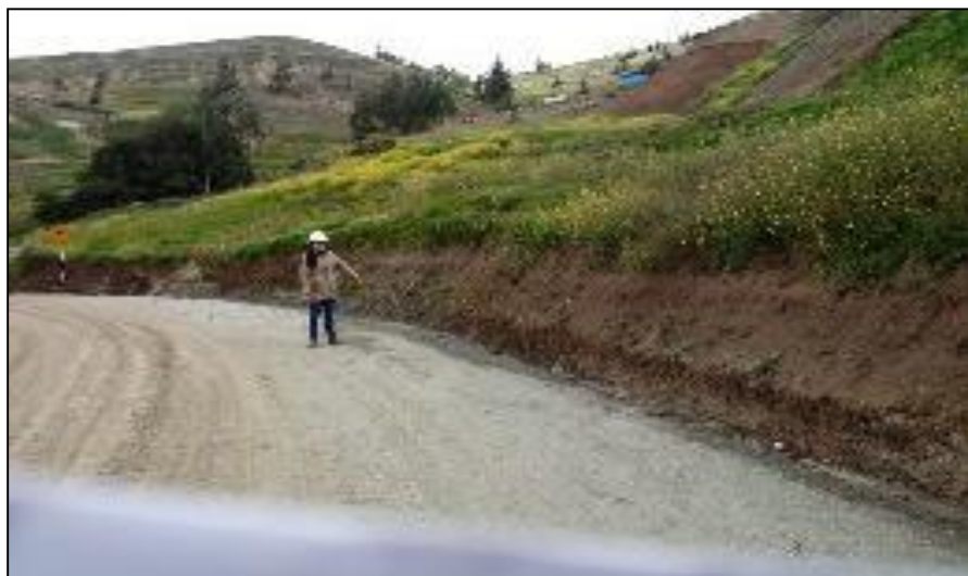
Figura 15, Vista del perfil del terreno con presencia del material limo arcilloso saturado.
