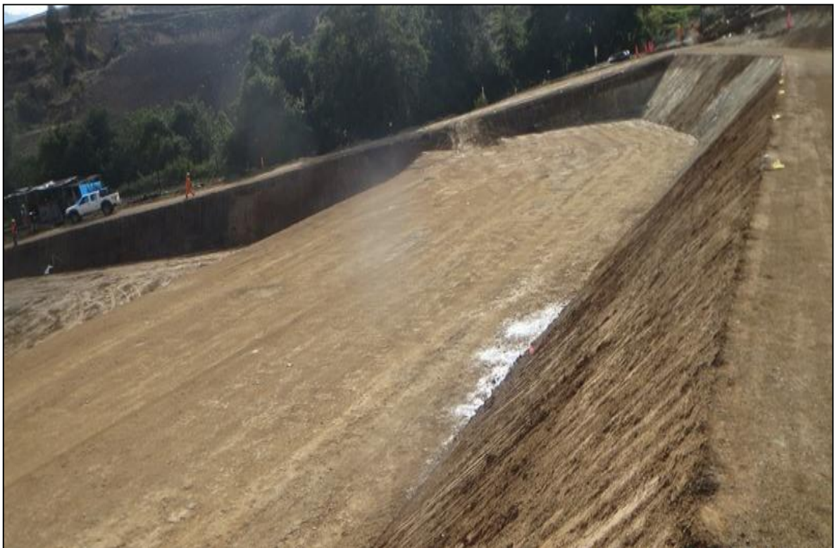
Figura 43, se visualiza el descenso del flujo sub superficial en las plataformas de las terrazas.
