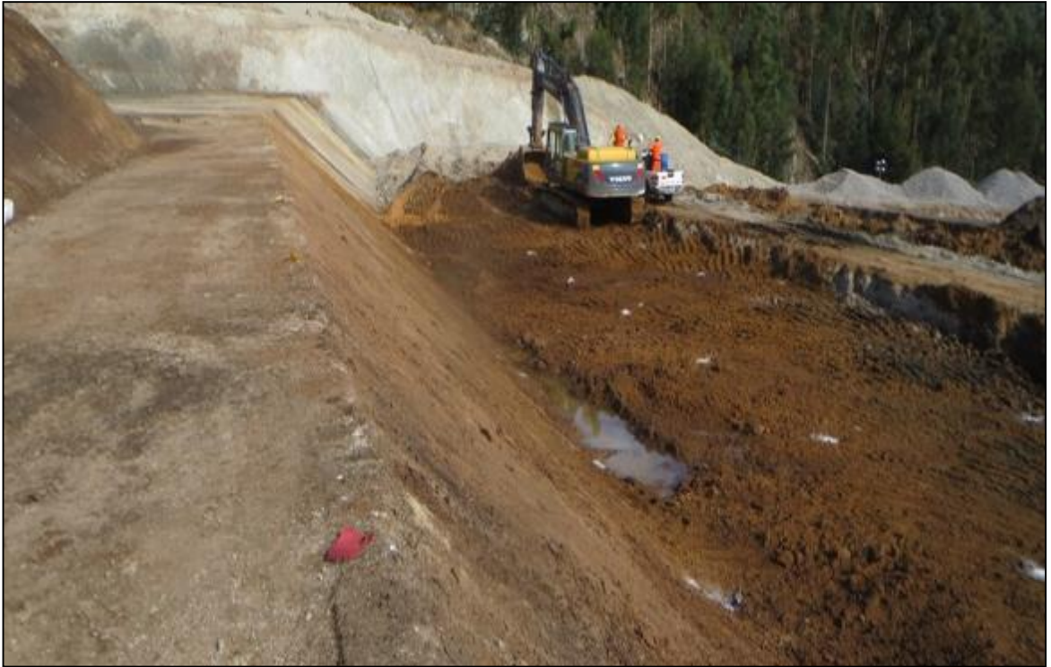
Figura 40, se observa la presencia del afloramiento del agua sub superficial en la terraza N°02.
