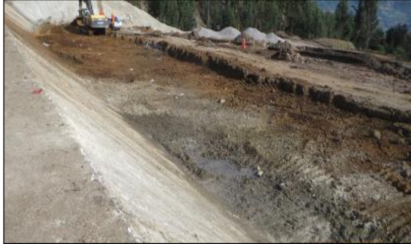
Figura 21,, Se observa el afloramiento de aguas subterráneas en terraza 02.
