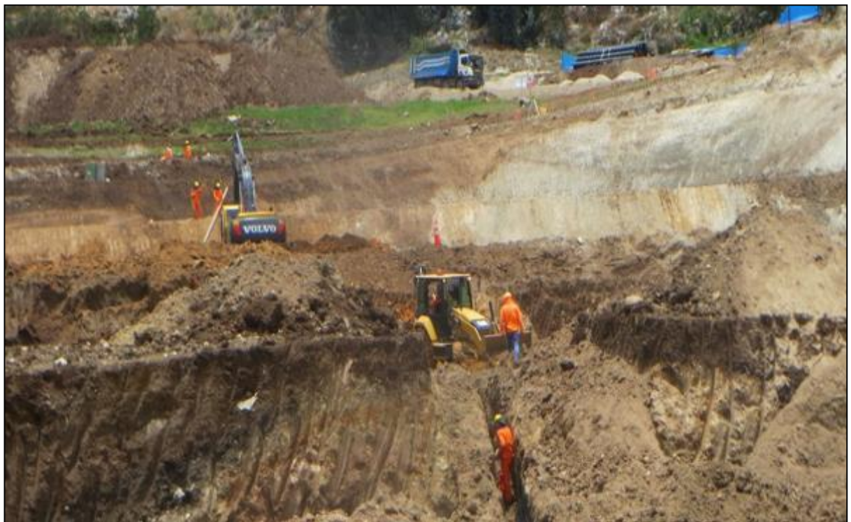
Figura 39, se observa la excavación de la zanja del lado izquierdo de las plataformas
