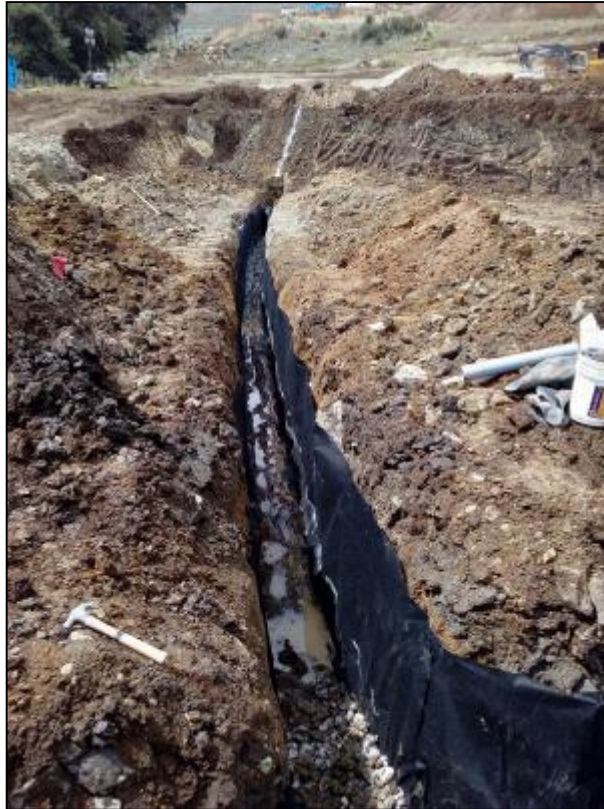
Figura 38, Presencia de agua subterránea durante la instalación de los subdrenes
