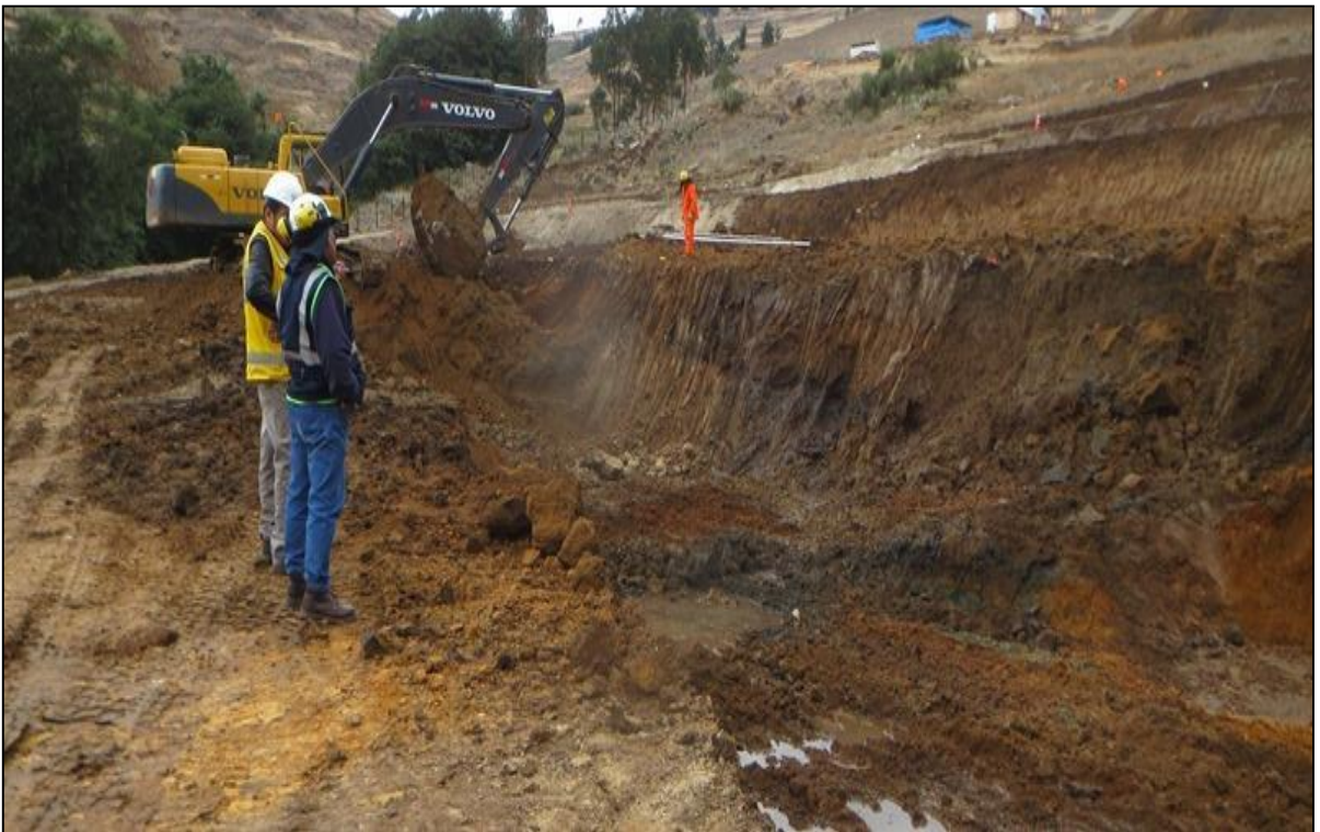
Figura 37, Vista de la presencia del suelo limo arcilloso saturado en la plataforma N°02
