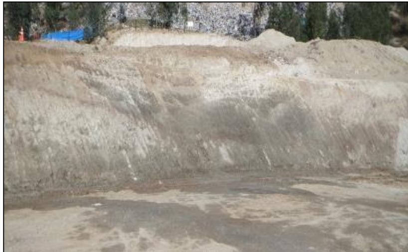
Figura 22, Vista del suelo húmedo en la plataforma de la terraza 03
