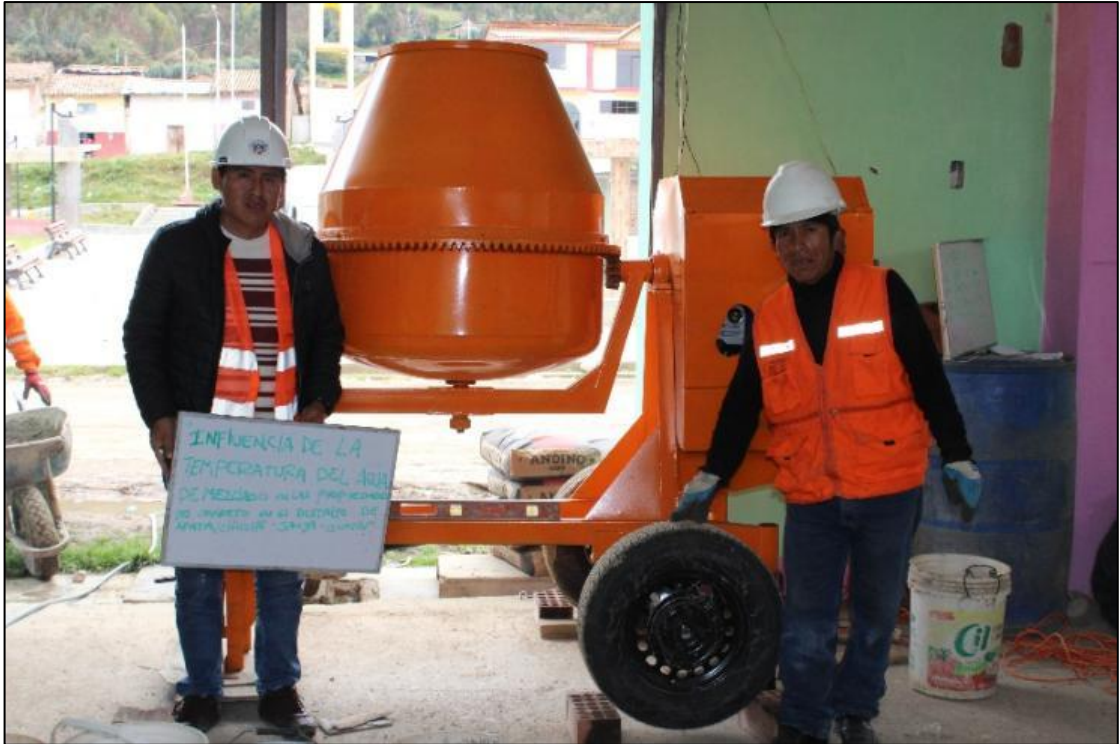
Fotografía 5. Revisión de la mezcladora adquirida, a fin de evitar cualquier problema de mezclado del concreto.
