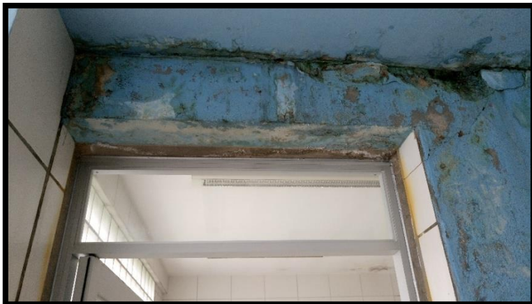
La humedad hace que se desprenda el revoque de la viga.
