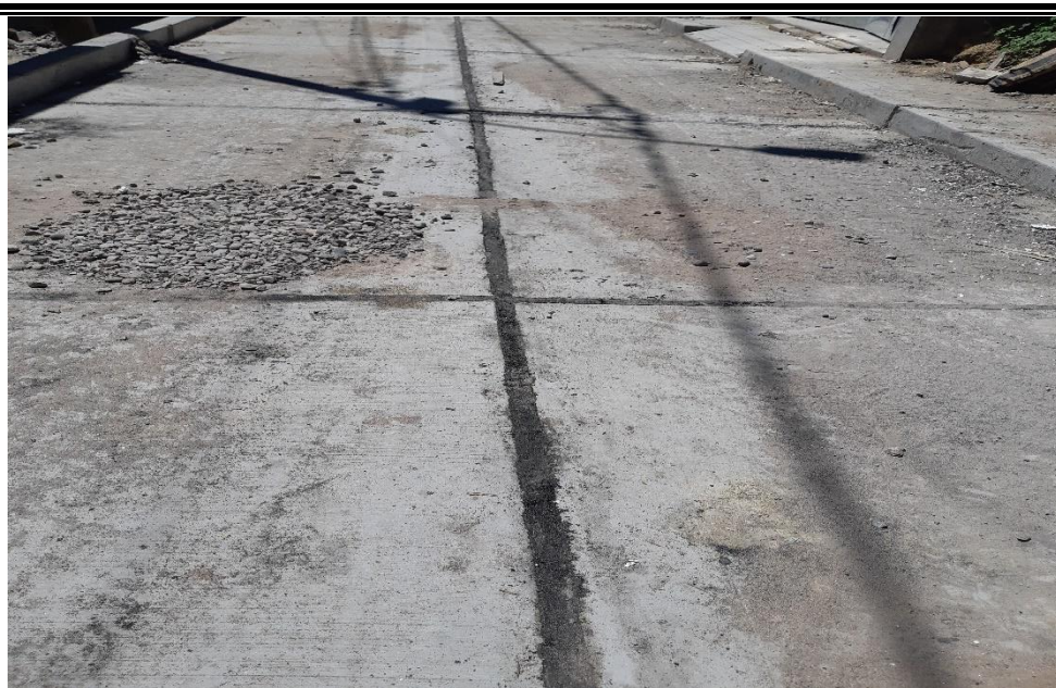
Fotografía N° 32: En imágenes observa el sellado de las juntas de dilatación del pavimento.
