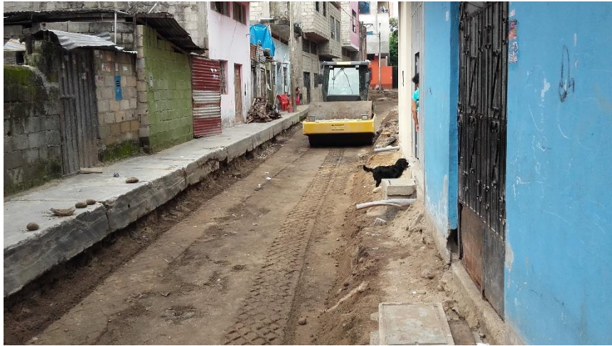
Fotografía N° 01: Conformación y Compactación de Sub Rasante - Pavimento del pasaje Los Cedros AA.HH. La Playa.
