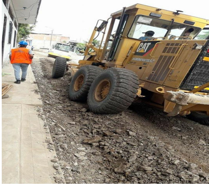
Fotografía N° 07: conformación de Base para pavimento con H=0.20m en el AA.HH. Señor de Los Milagros.
