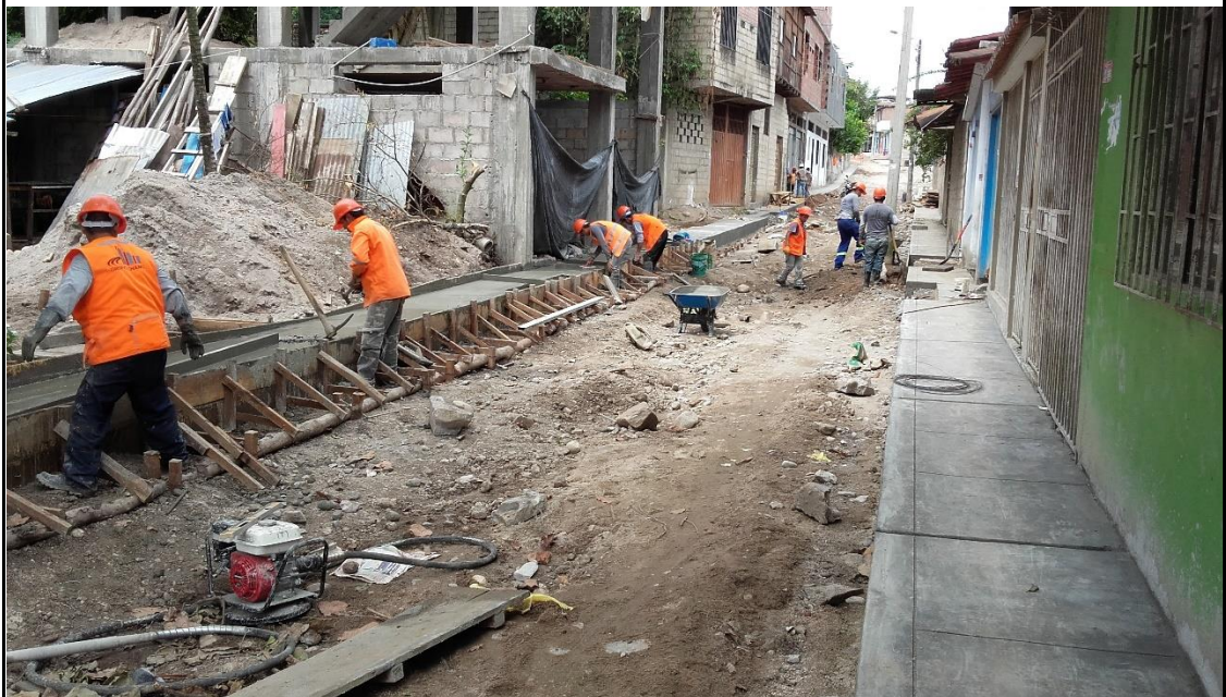
Fotografía N° 14: Acabado y Buñado de veredas AA.HH. Señor de Los Miagros– margen izquierda
