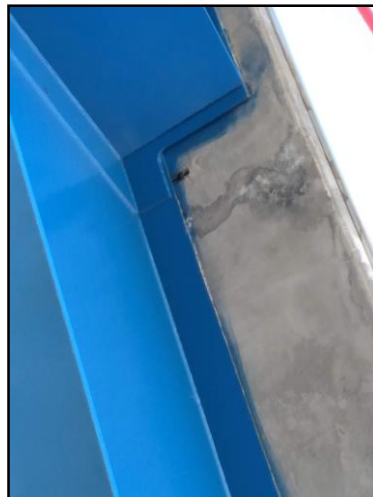
Fotografía de Eflorescencia en el Tablero
