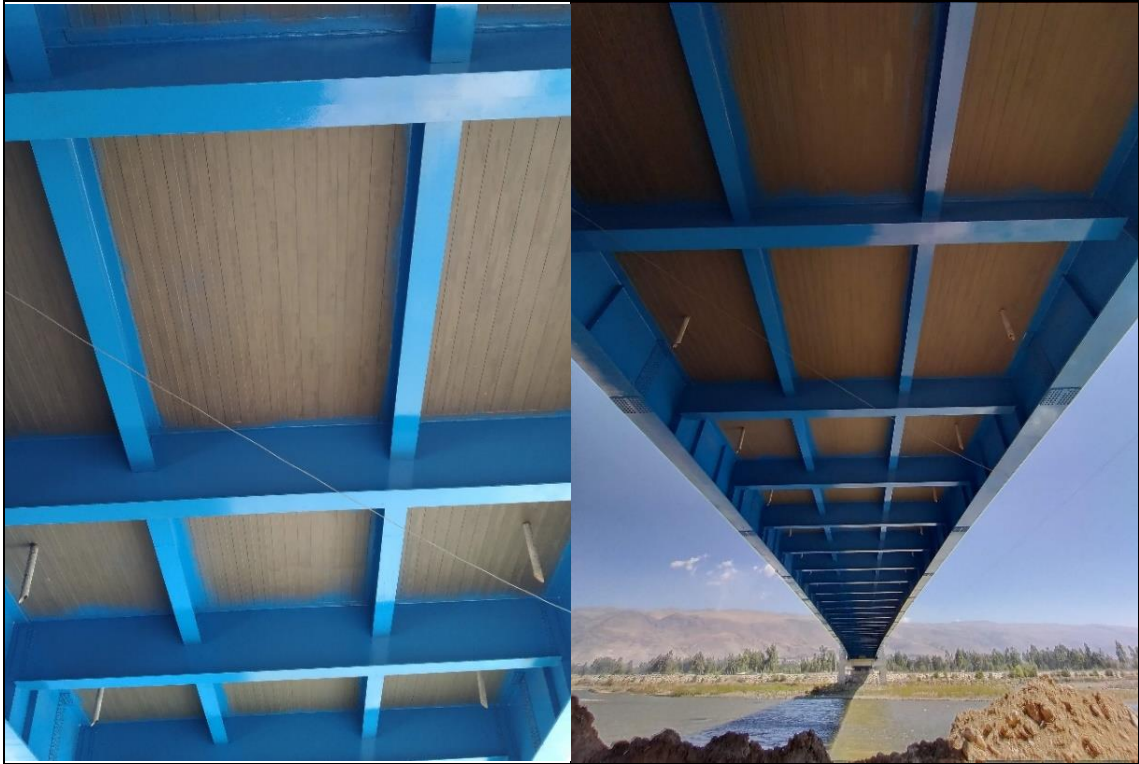
Lámina de fibra de carbono en la parte inferior de la plataforma del puente.
