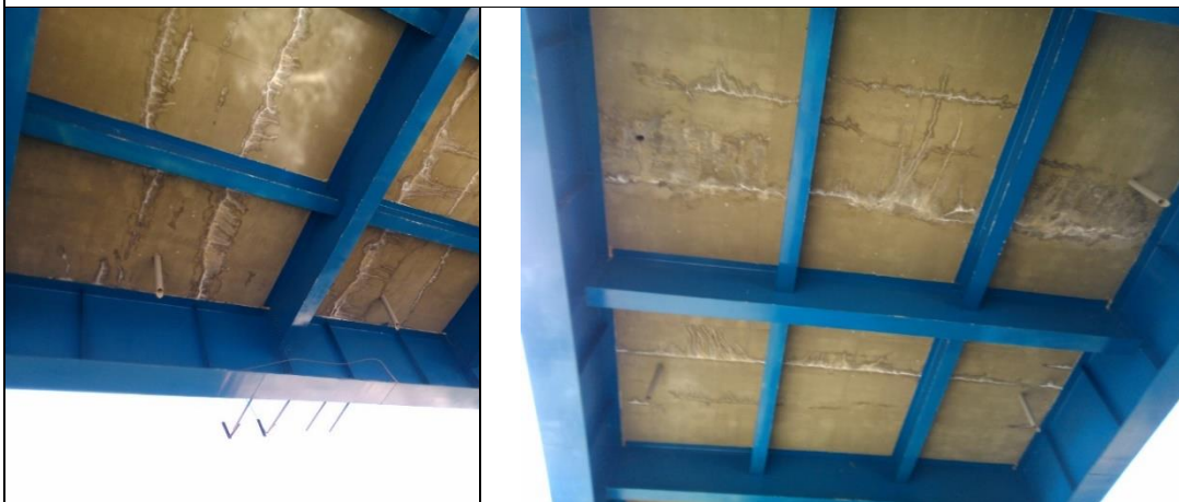
Fisuras en la parte inferior de la plataforma del Puente Comuneros I del tramo central
