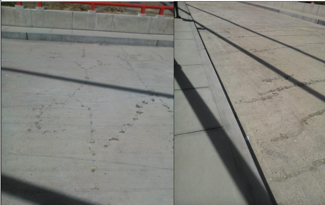
Fisuras en la parte superior de la plataforma del tramo central del puente.
