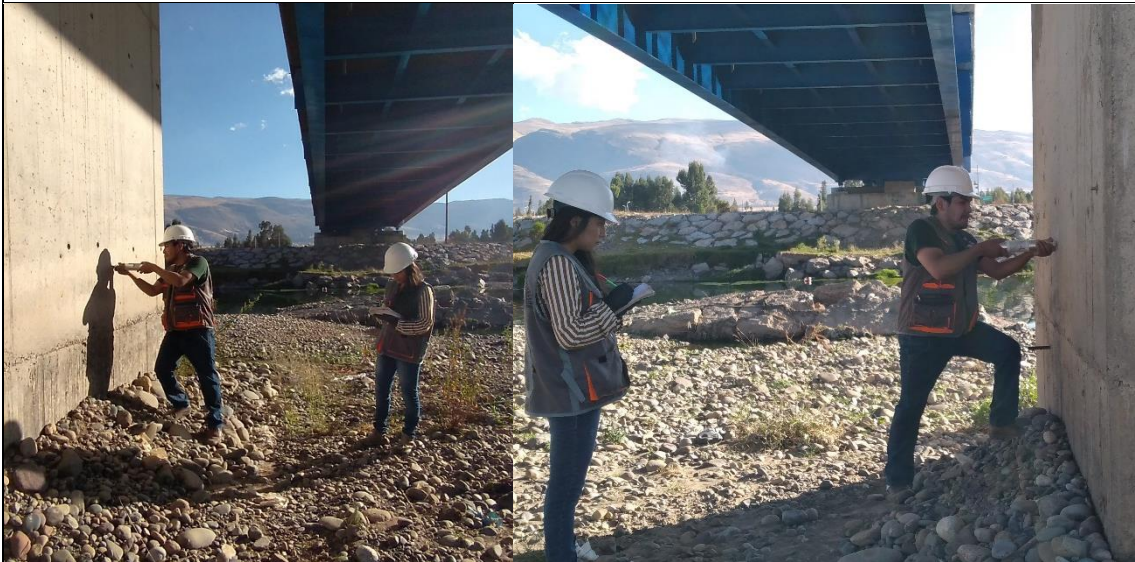
Toma de datos del esclerómetro en el pilón de la margen derecha.
