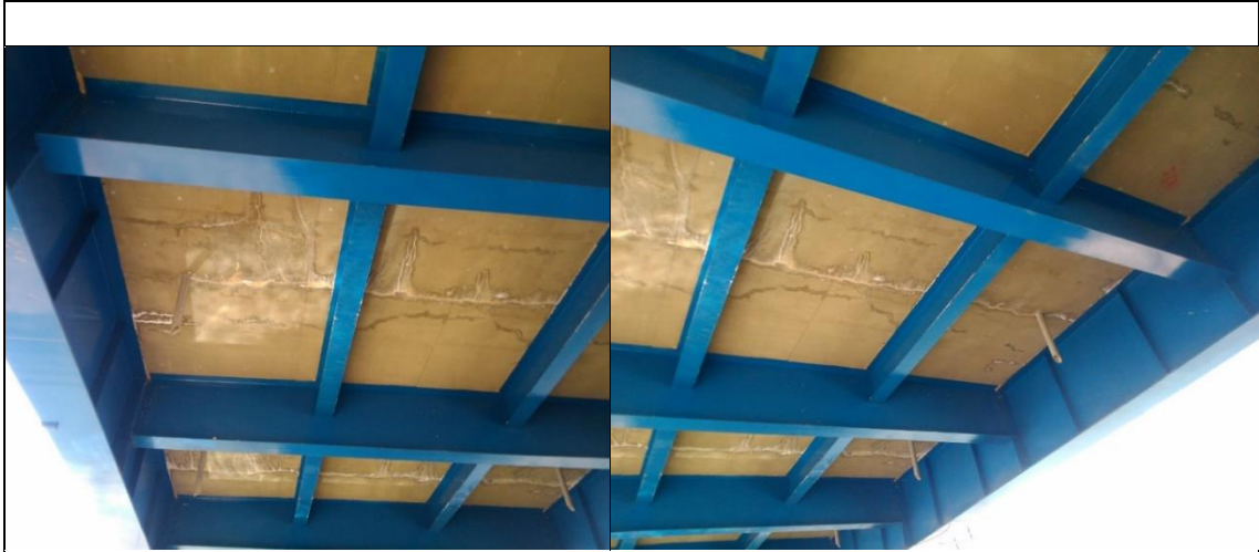
Fisuras en la parte inferior de la plataforma del Puente Comuneros I del tramo central
