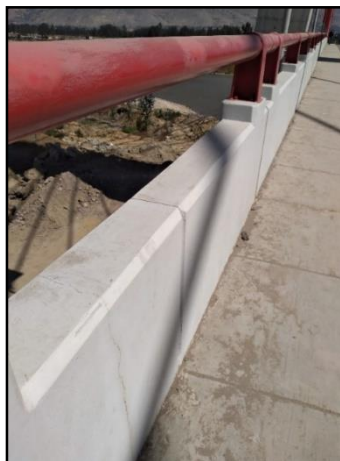
Fotografía del Desgaste de la Pintura
