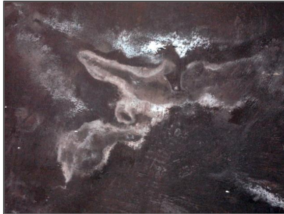
Fotografía de la Eflorescencia en el Concreto
