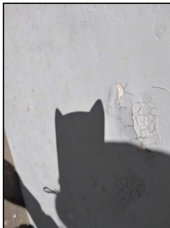
Fotografía del Desconchado de la Pintura
