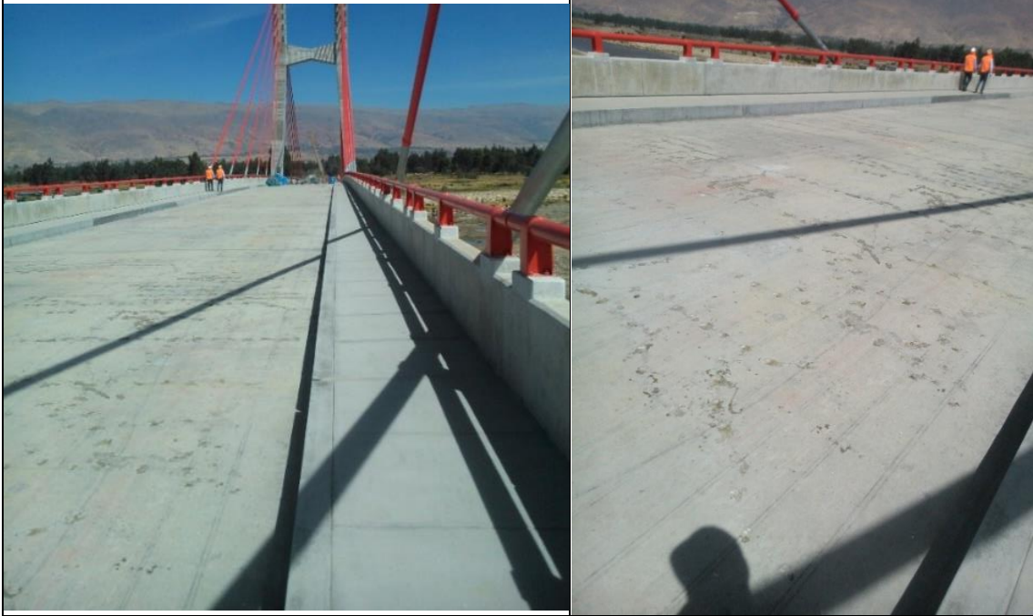
Fisuras en la parte superior de la plataforma del tramo central del puente
