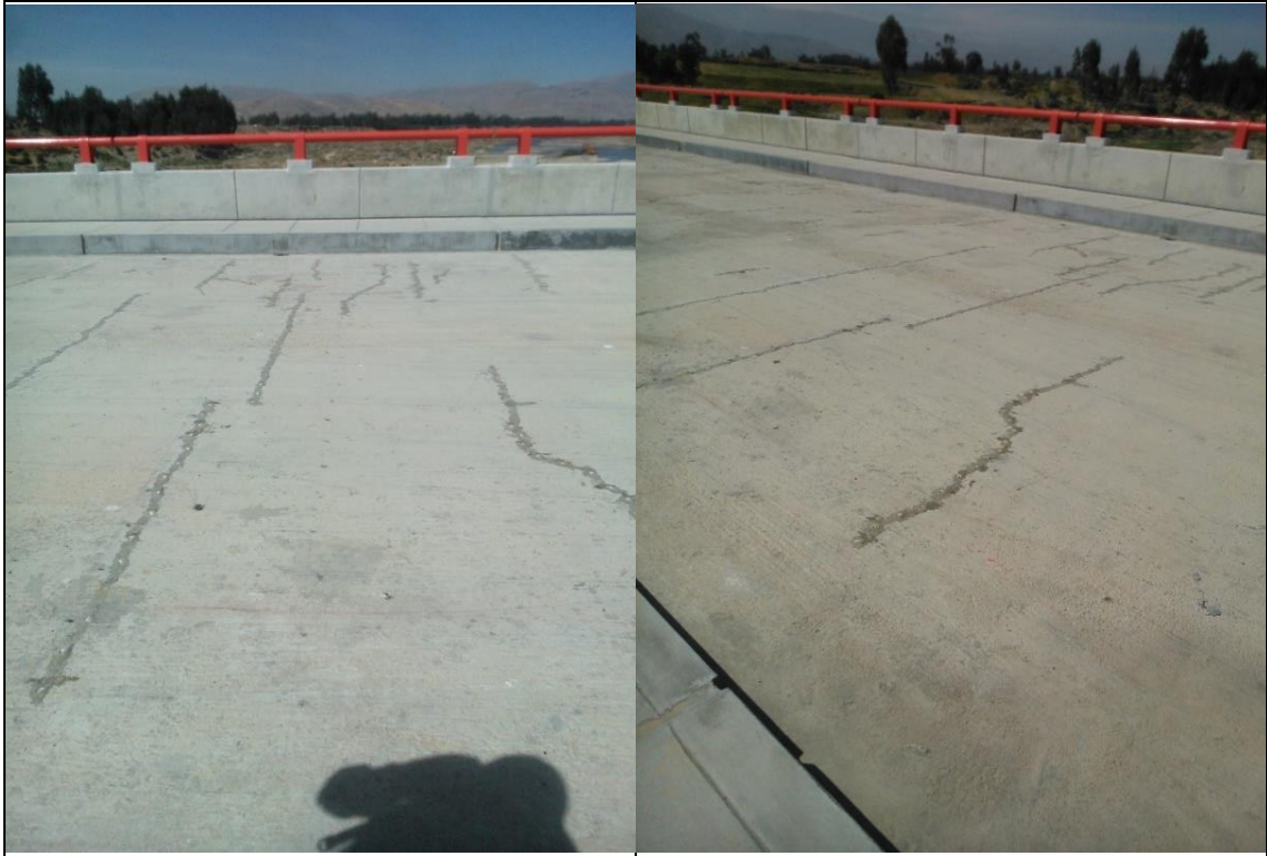
Fisuras en la parte superior de la plataforma del Puente Comuneros I de la margen izquierda.
