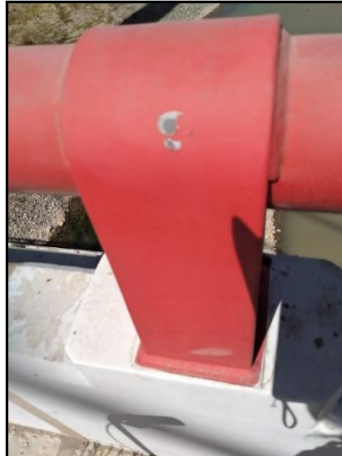
Fotografía del Desprendimiento de la Pintura
