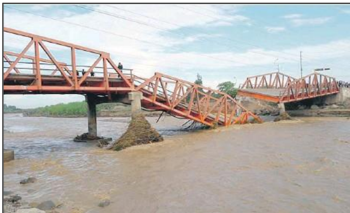
Fotografía del Colapso del Puente Virú
