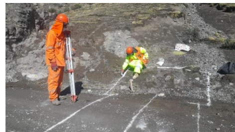
Imagen 04: en las imágenes se observan el replanteo, la colocación del punto de referencia del eje, el pintado del detalle de alcantarilla y el trazo de alcantarilla.
