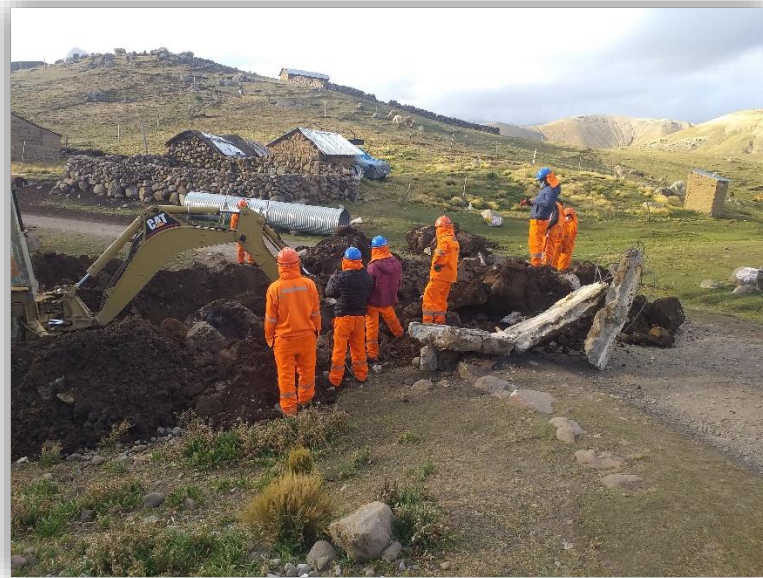
Imagen 06: en la imagen se observa como el personal está en espera de que la maquinaria termine de excavar para poder realizar las demás actividades, el cual genera una deficiencia en la productividad de mano de obra.
