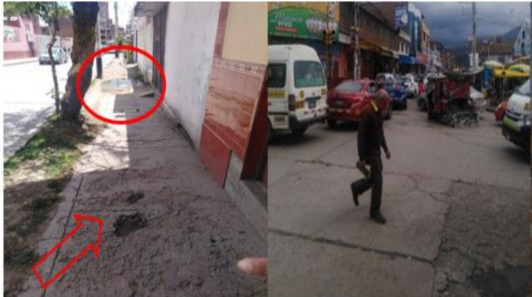
Figura 1. Situación actual en pistas y veredas en mal estado e inexistente.
