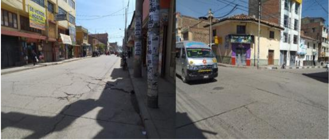
Vista de la intersección III entre el Jr. Parra del Riego y el Jr. Santa Isabel, la cual no muestra señalización y vista del tramo III entre el Jr. Parra del Riego y el Jr. Julio C. Tello.
