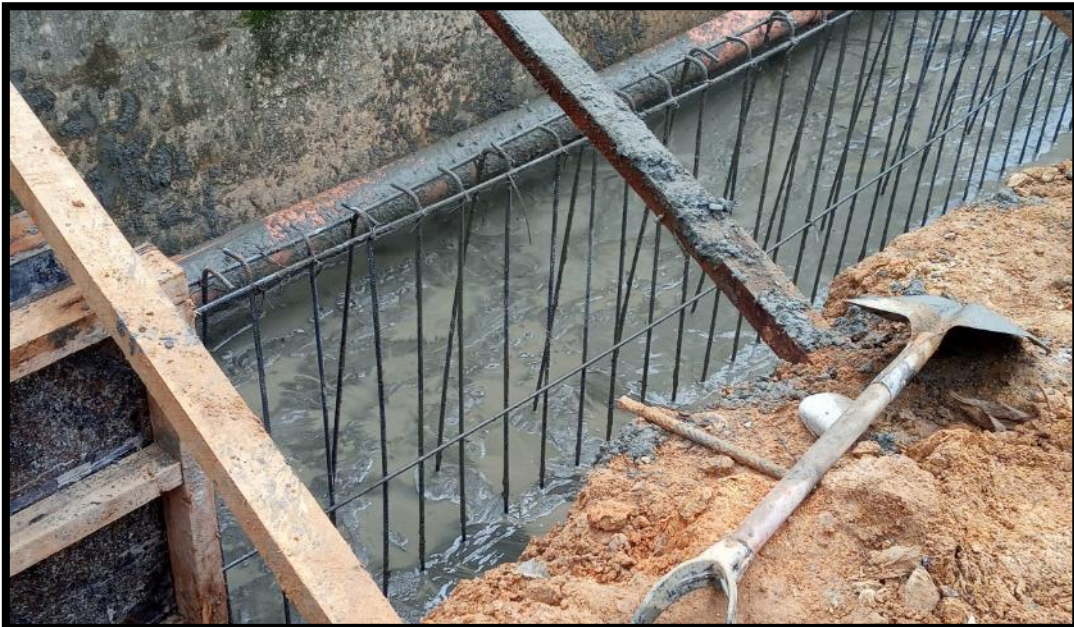
Fotografía 4, Fotografía 5, Fotografía 6 y Fotografía 7: Cimentación de Muro de Contención en obra en Huancayo
