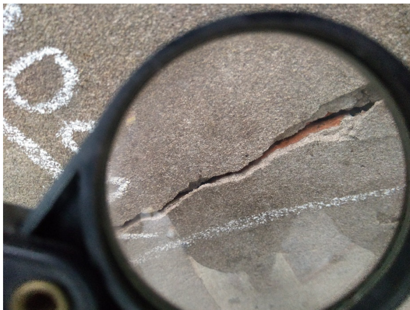
Imagen 12: ampliación de grietas Fuente: Elaborado por el autor
