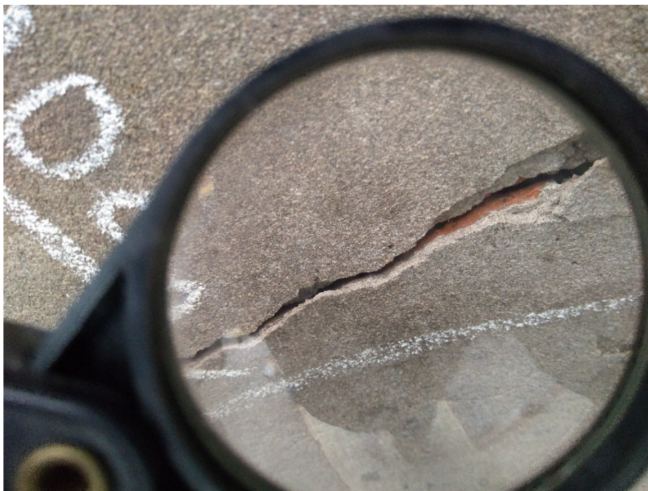
Imagen 16: Se aprecia el desprendimiento del ladrillo de techo respecto a la viga de techo. Fuente: Elaborado por el autor
