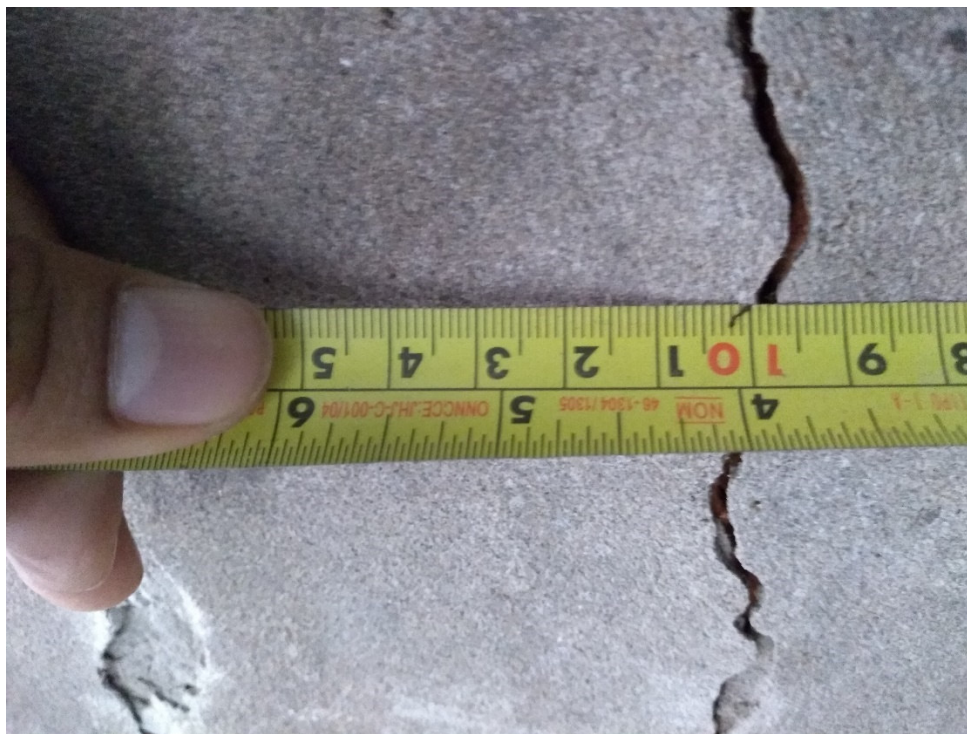
Imagen 18: Ancho de fisura en techo existente. Fuente: Elaborado por el autor
