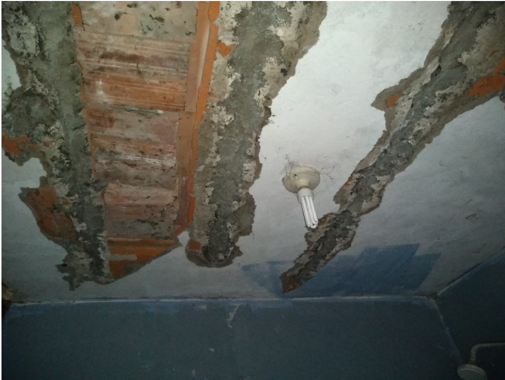
Imagen 20: Desprendimiento en viguetas, ambiente Baño. Fuente: Elaborado por el autor
