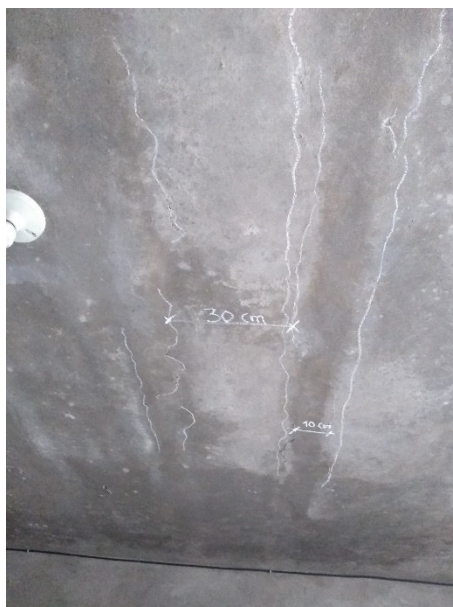
Imagen 1: Fisura en losa aligerada Fuente: Elaborado por el autor
