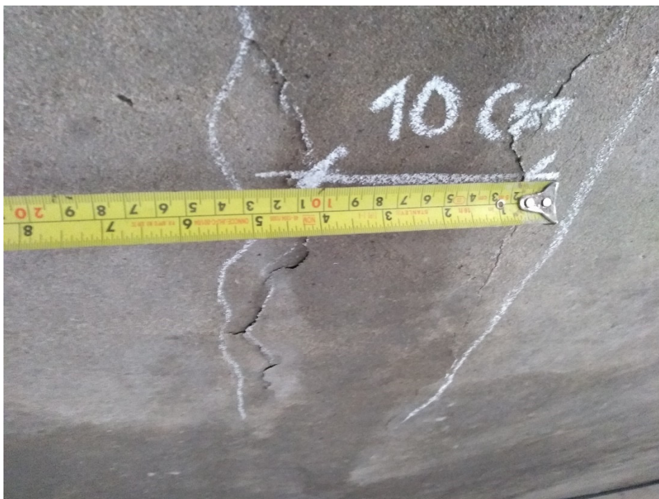
Imagen 15: Desprendimiento del ladrillo de techo. Fuente: Elaborado por el autor
