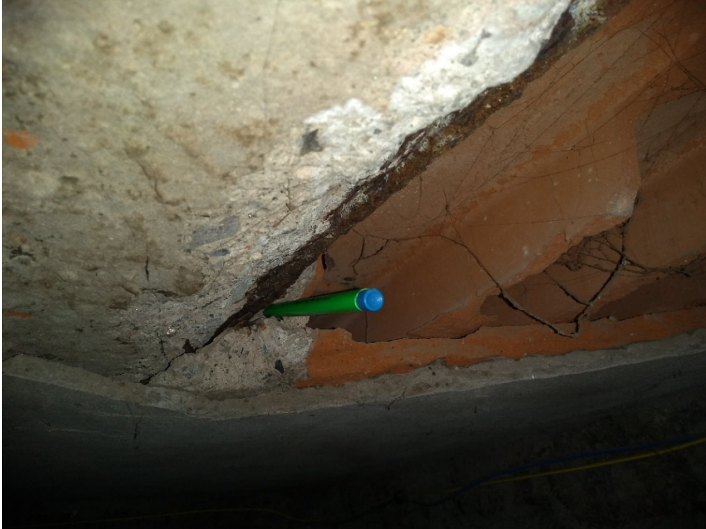
Imagen 19: Fractura del concreto por aumento de volumen de la barra oxidada. Fuente: Elaborado por el autor
