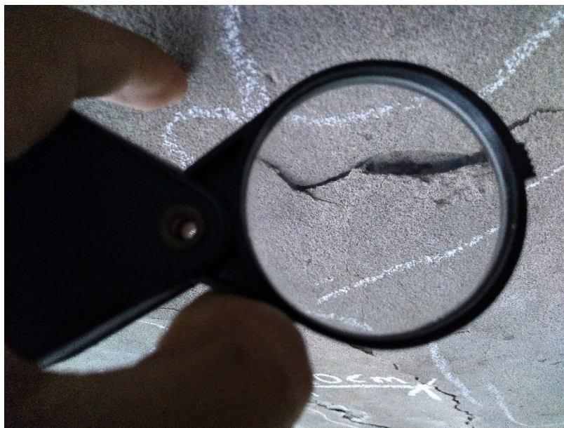
Imagen 2: Daño puntual en losa aligerada Fuente: Elaborado por el autor
