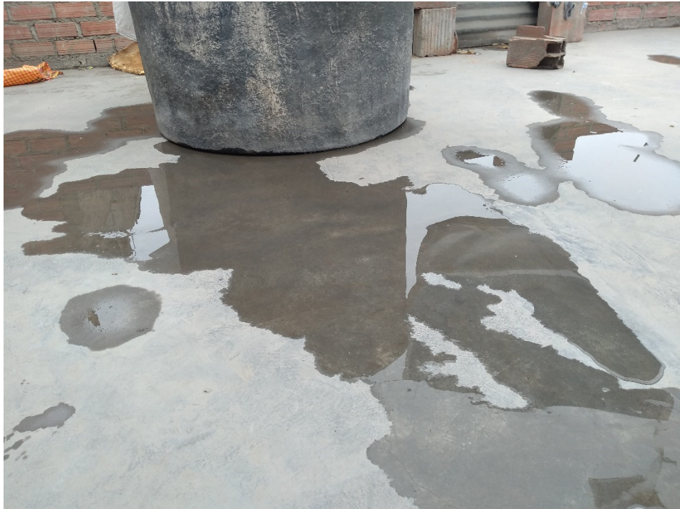
Imagen 21: Acumulación de agua de lluvia Fuente: Elaborado por el autor
