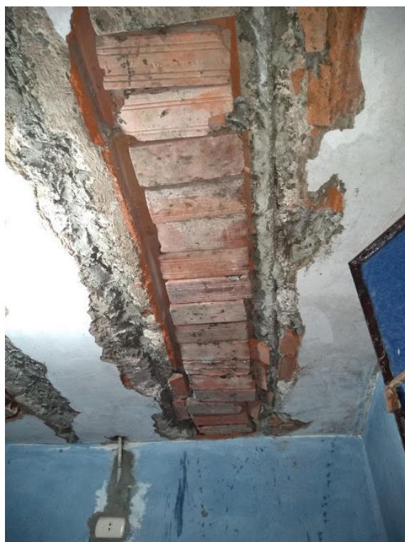
Imagen 13: Viguetas dañadas (zona Baño) Fuente: Elaborado por el autor
