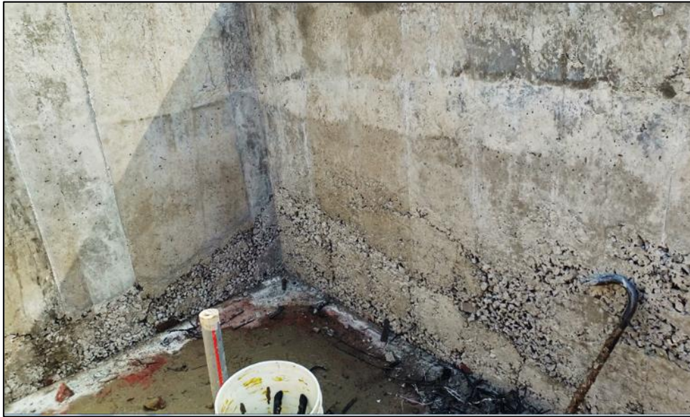
Figura 2 Patología en elementos estructurales
