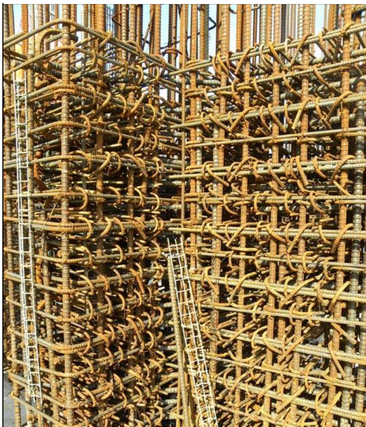
Figura 1 Estructuras con Refuerzo Denso
