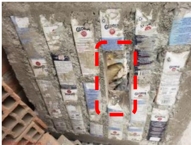
Figura 256. Muro con eco ladrillo desprendido
