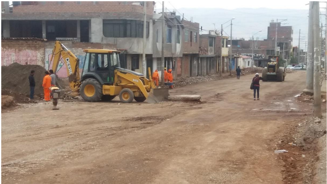
Observamos la compactación de la Sub Rasante de la Av. San Isidro.
