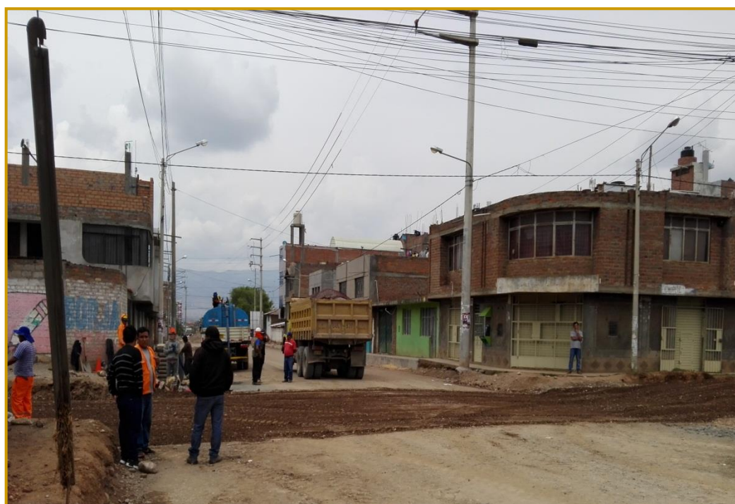
Vista de los trabajos de movimiento de tierras para la conformación de sur rasante en el Jr. Huayna Capac
