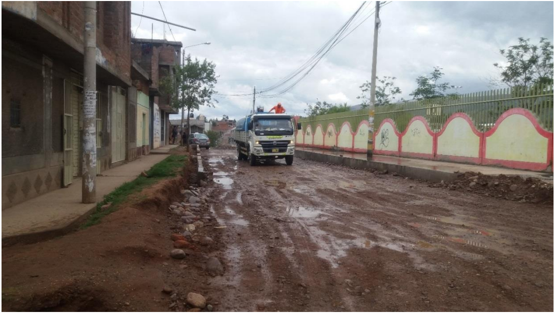
En la foto se observa el riego de la sub rasante, para la compactación y conformación del Jirón Huayna Capac (Polideportivo Juan Parra del Riego)
