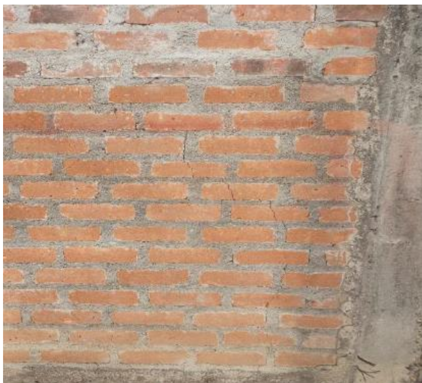
Figura 01: Falla por corte
