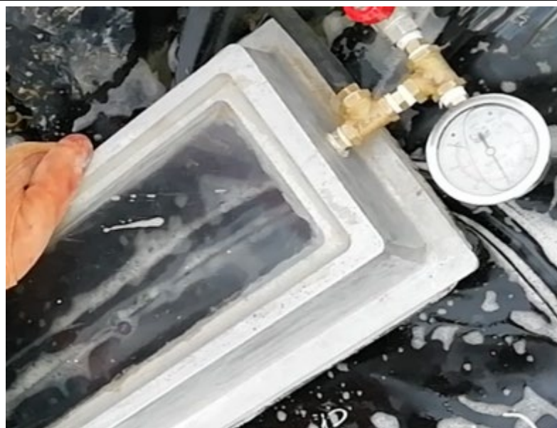
Foto 14: Ensayo de caja de vacío
