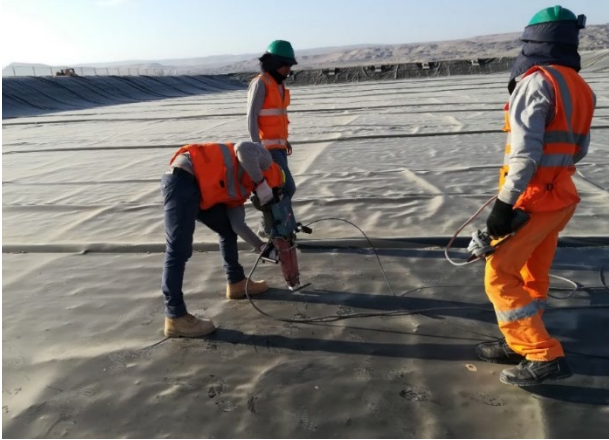
Foto 9: Parchado de fallas encontradas
