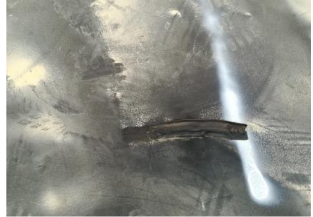
Foto 10: Parchado de falla encontrada
