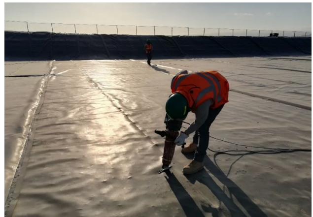
Foto 8: Parchado de fallas encontradas
