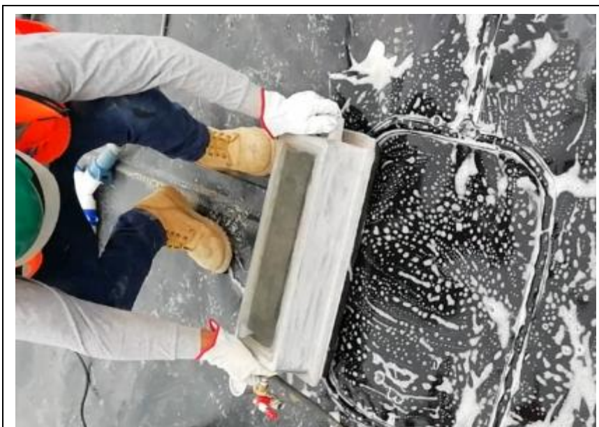
Foto 13: Ensayo de caja de vacío
