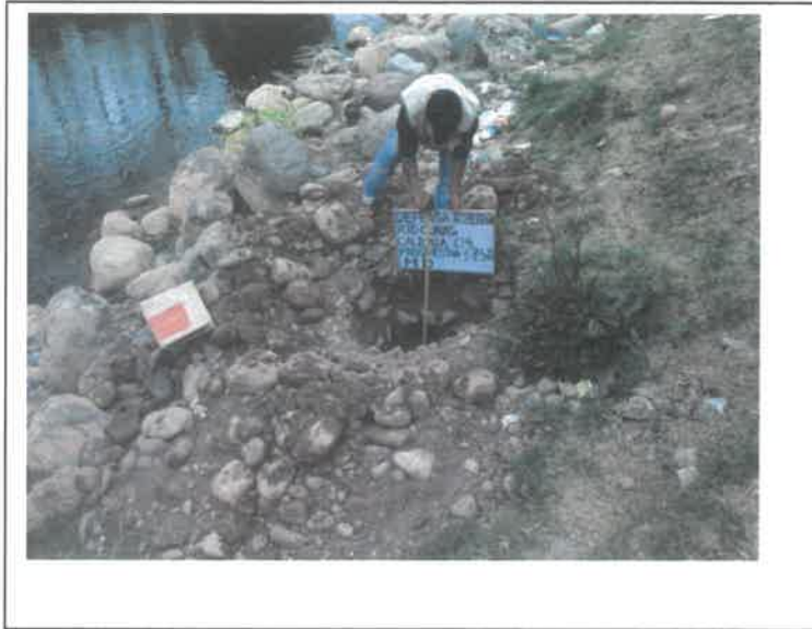
FOTO. 13.- PROFUNDIDAD DE EXCAVACION. C-4, PROG, 1+750 . INFLUENCIA DE LOS MUROS DE GAVIONES O MUROS DE CONCRETO EN LAS DEFENSAS RIBEREÑAS DEL RIO CUNAS CHUPACA, 2020
