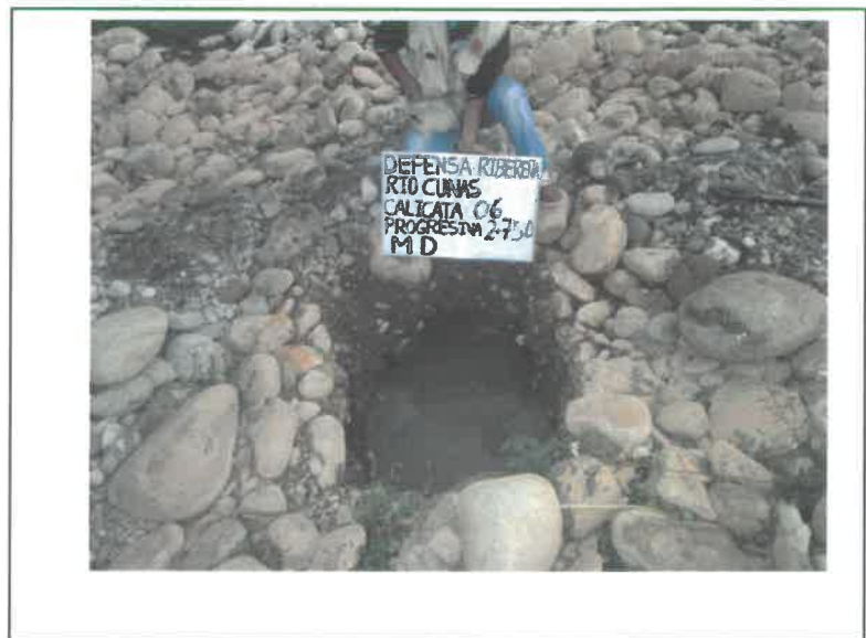
FOTO. 18.-PERFIL ESTRATIGRAFICO DE LA CALICATA. C- 6 PROG, 2+750 . INFLUENCIA DE LOS MUROS DE GAVIONES O MUROS DE CONCRETO EN LAS DEFENSAS RIBEREÑAS DEL RIO CUNAS CHUPACA, 2020
