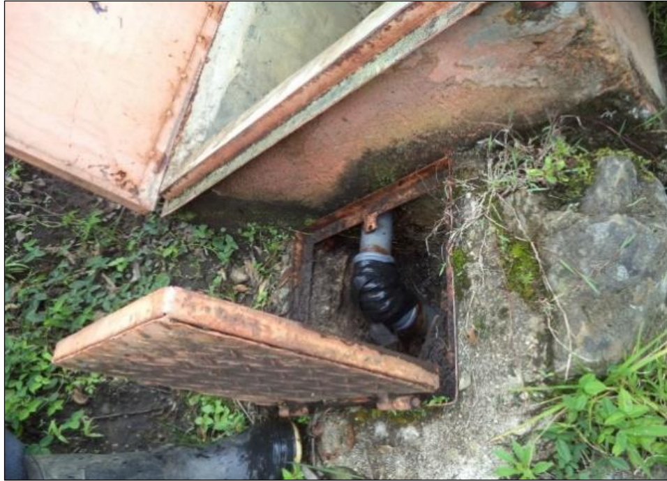
Imagen 8: Captación de agua en mal estado de Rodiopampa
