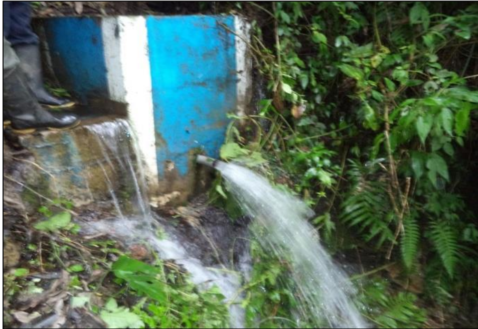
Imagen 7: Captación de agua en mal estado de Balcón
