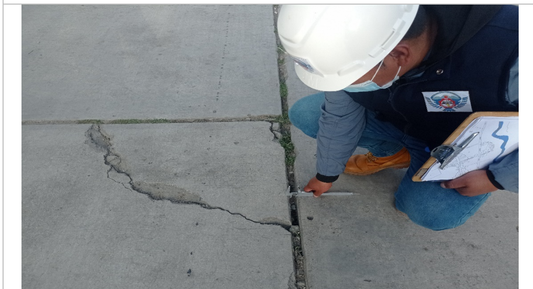
Figura 25 – Daño en el sello de junta
