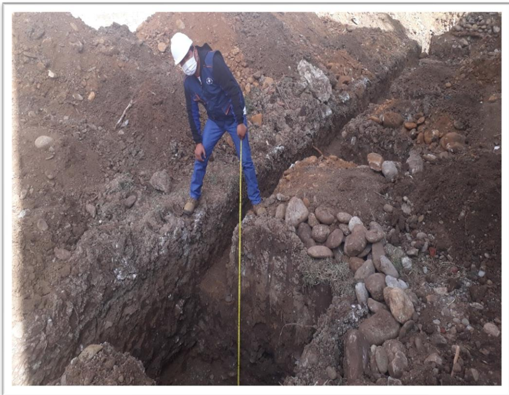
Vista 02.- En la vista se observa la verificación de la altura de zapatas.
