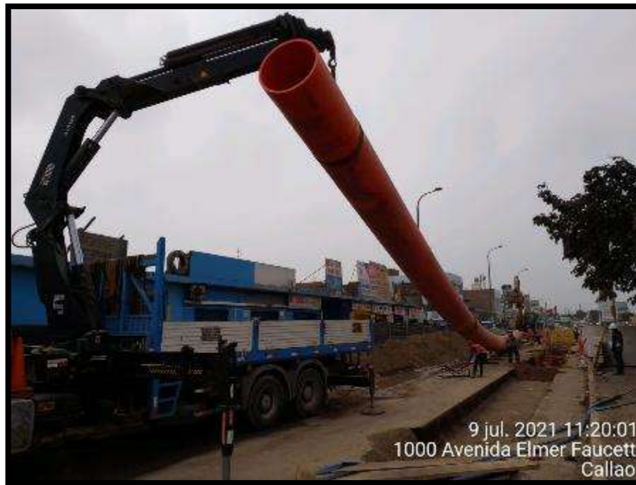
Fig.03.- Se realizarán trabajos de alto riesgo, con tuberías de 1000mm de diámetro, con el apoyo del camión grúa y la excavadora, en la obra de saneamiento.
