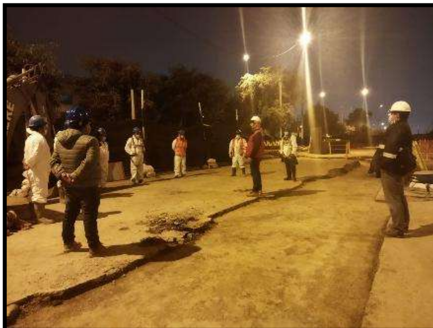
Fig.08.- Se brindarán charlas para trabajos nocturnos, frente a trabajos de empalme de tuberías de 1000mm de diámetro en redes de líneas primarias.
