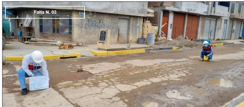
Figura 14. Identificación de fallas sección “C”
