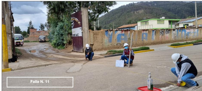
Figura 15. Identificación de fallas sección “C”
