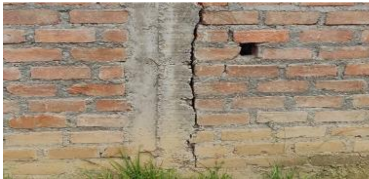
Figura 1: presencia de grietas en muro cercano al lugar de estudio
