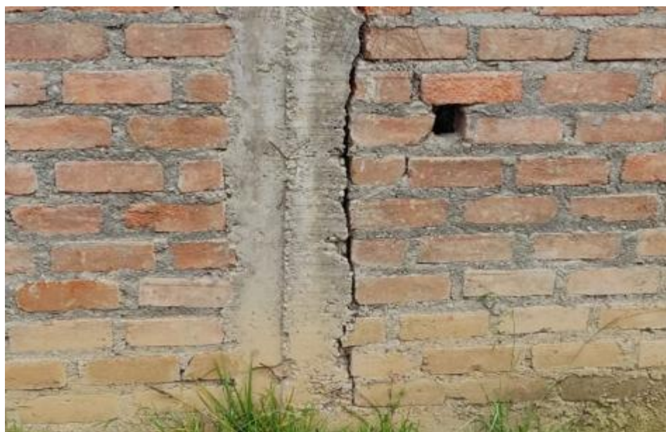
Fotografía 1: Presencia de grietas en vivienda de 1 piso cercana al lugar de estudio
