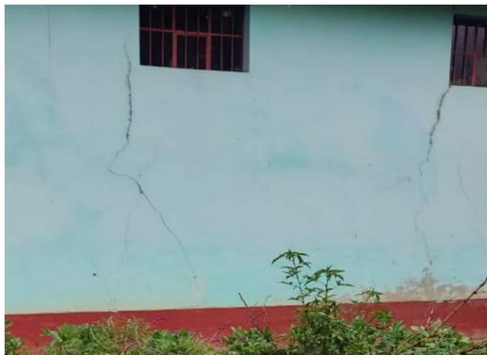
Fotografía 2: Presencia de fisuras en otra vivienda cercana al lugar de estudio
