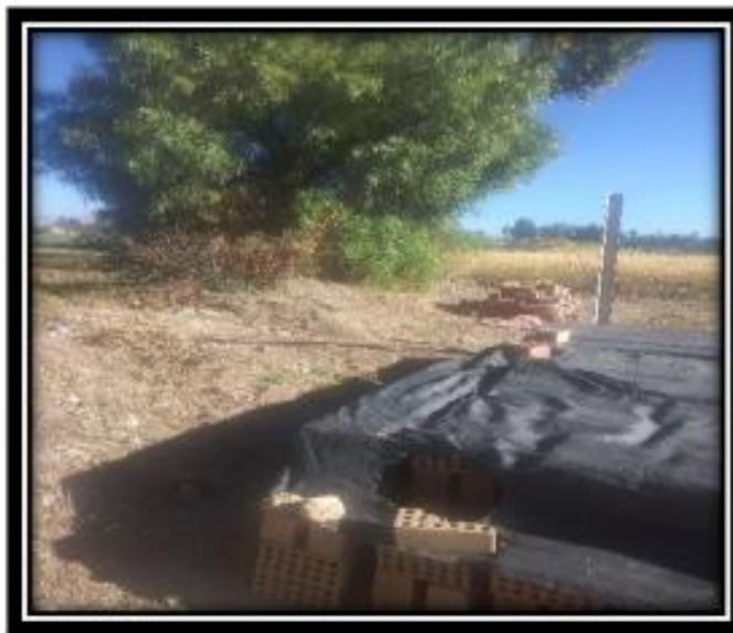
Tapado de ladrillo ya que estaba lloviendo y que se podría deteriorar el ladrillo
