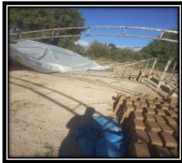
El techo se cayó por el viento fuerte ya que estaba deteriorado los amarres
