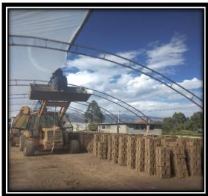
Tendido del plástico para el nuevo techo de área de los ladrillos de 18 huecos
