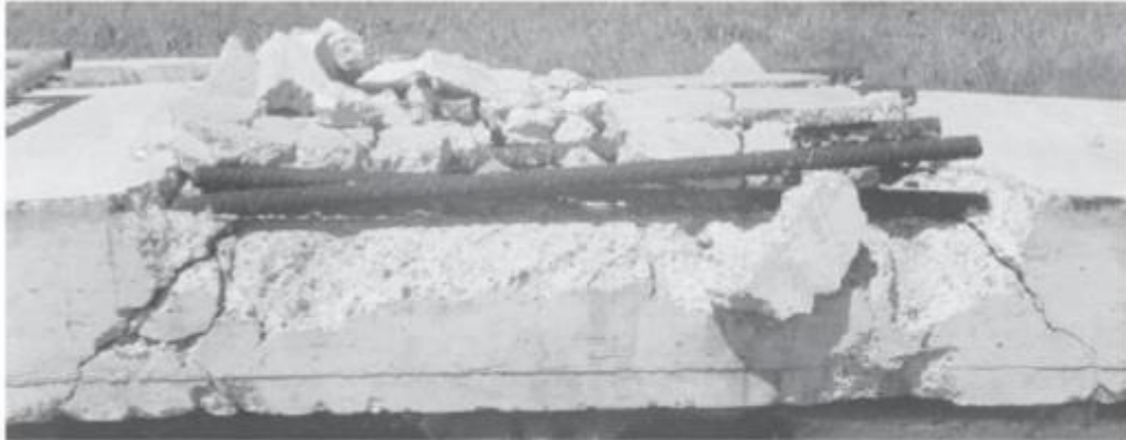
Figura 9- Daño en una viga debido a un mal traslape del acero longitudinal superior.
