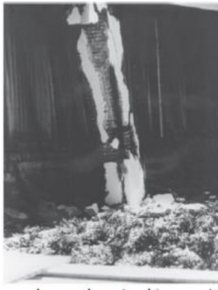
Figura 8- Daño de una columna durante el terremoto de San Francisco de 1971 (E.E.U.U.).
