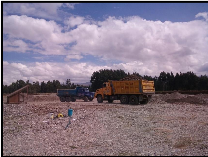
En la imagen se puede observar al volquete que está en pleno transporte de los materiales al borde del río.
