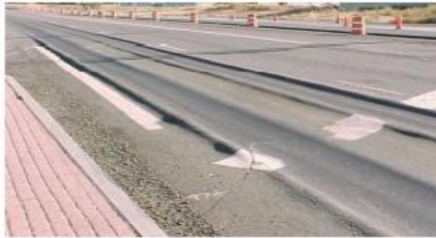
Figura N° 30: Ahuellamientos, Nivel de severidad (H)
