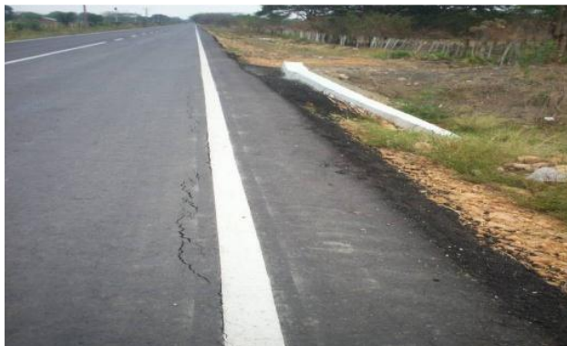
Figura N a 12: Grietas de Borde, Niveles de severidades (L)
