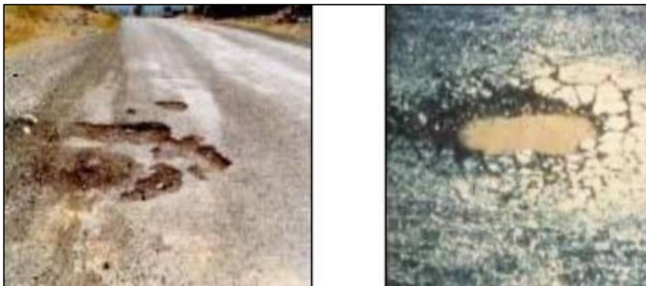
Figura Nª 37: Baches, Nivel de severidad (H)
