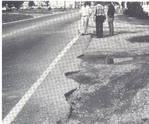
Figura N a 14: Grietas de Borde, Nivel de severidad (H)
