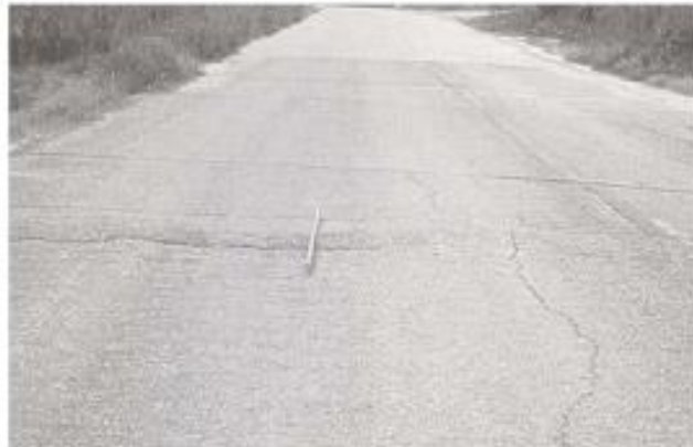
Figura Nª 33: Hinchamientos, Nivel de severidad (M)
