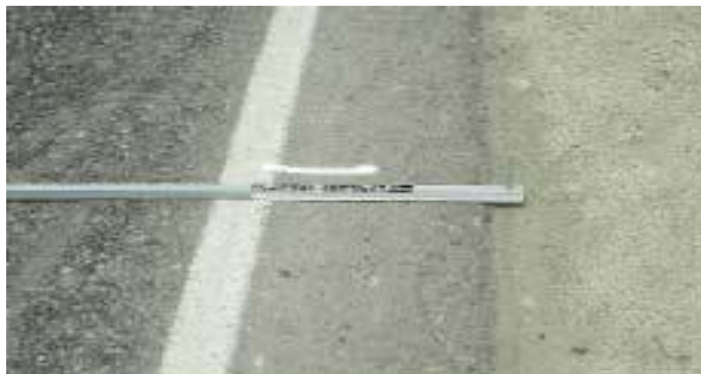
Figura Nª 45: Desnivel de Carril – Berma, Nivel de severidad (L)
