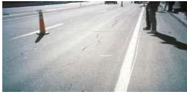
Figura Nª 06: Piel de Cocodrilo, Nivel de severidad (L)
