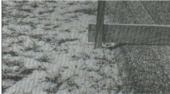
Figura Nª 46: Desnivel de Carriles – Bermas, Niveles de severidades (M)
