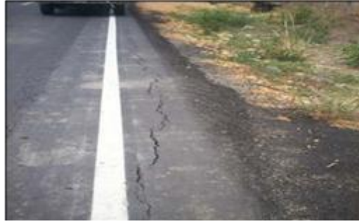
Figura N a 13: Grietas de Bordes, Niveles de severidad (M.)
