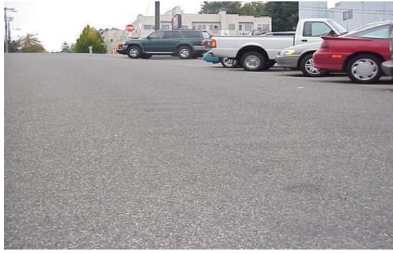
Figura Nª 23: Corrugaciones, Nivel de severidad (L)
