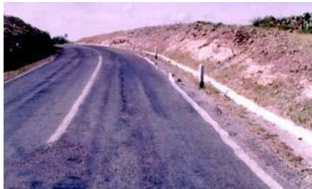
Figura Nª 34: Hinchamientos, Nivel de severidad (H)
