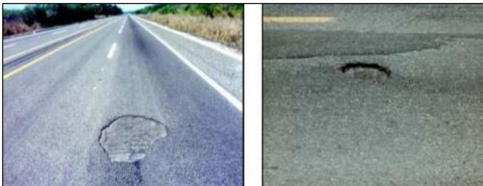
Figura Nª 36: Baches, Nivel de severidad (M)
