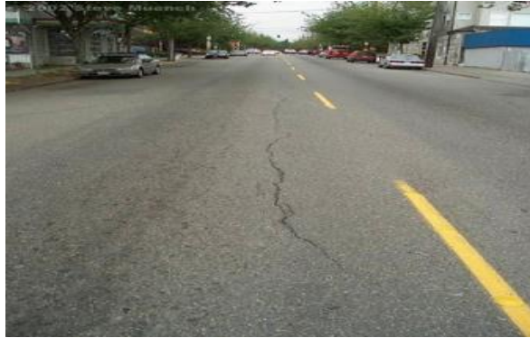
Figura N a 18: Grietas de Borde, Nivel de severidad (L)
