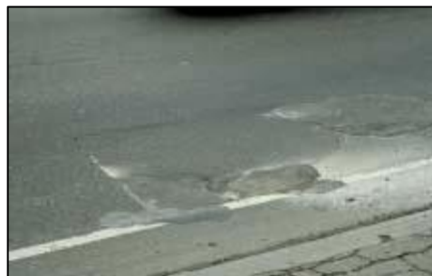
Figura Nª 50: Bacheo y Zanjas reparadas (Parches), Nivel de severidad (H)
