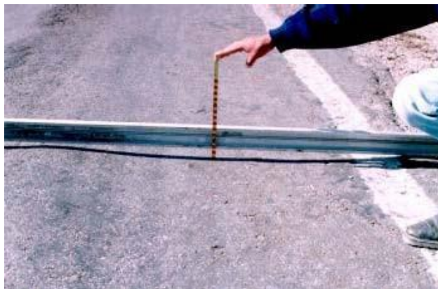
Figura Nª 29: Ahuellamientos, Nivel de severidad (M)
