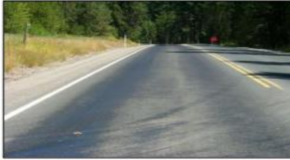
Figura N a 41: Mancha en pavimentos (exudación), Nivel de severidad (L)
