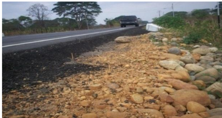
Figura Nª 47: Desniveles de Carriles – Bermas, Nivel de severidades (H)
