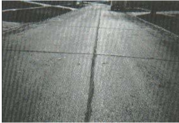
Figura Nª 15: Grietas de Reflexión de Juntas, Nivel de severidad (L)
