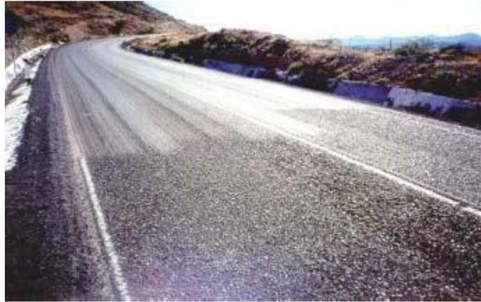
Figura N o 39: Peladura por Interperismo, Nivel de severidad (M)
