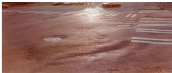
Figura Nª 52: Desplazamiento, Nivel de severidad (H)
