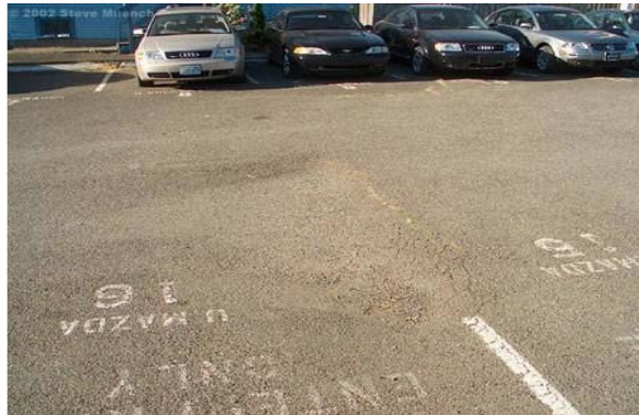
Figura Nª 21: Abultamientos y/o Hundimientos, Nivel de severidad (M)
