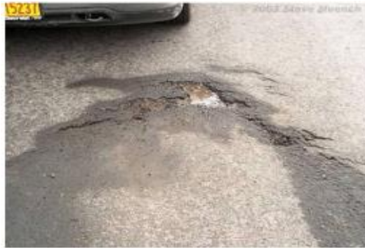
Figura N° 32: Desplazamientos, Nivel de severidad (H)
