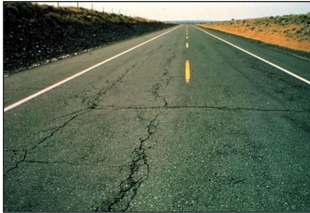
Figura Nª 09: Grietas de contracción (Bloque), Nivel de severidad (L)
