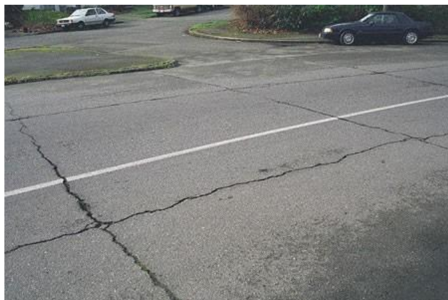
Figura Nª 16: Grietas de Reflexión de Juntas, Nivel de severidad (M)
