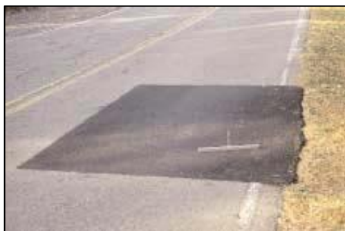
Figura Nª 48: Bacheo y Zanjas reparadas (Parches), Nivel de severidad (L)
