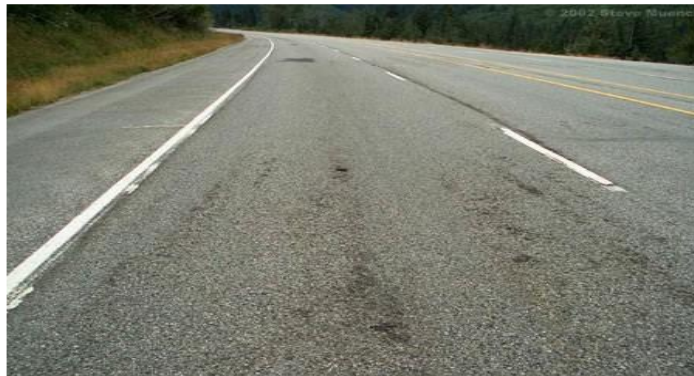
Figura Nª 38: Peladura por Interperismo, Nivel de severidad (L)
