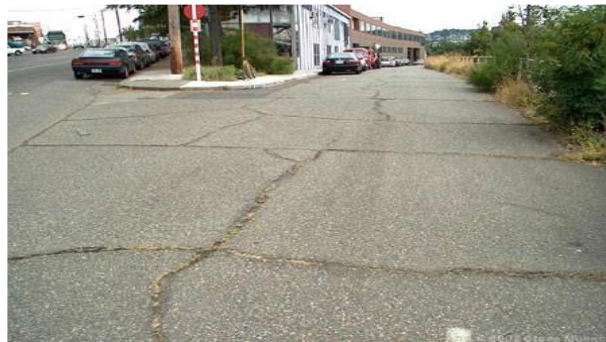
Figura Nª 17: Grietas de Reflexión de Juntas, Nivel de severidad (H)
