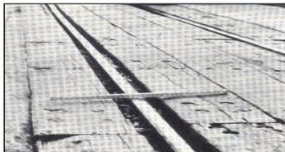
Figura Nª 53: Cruce de sumideros de rejilla (cruce de rieles), Nivel de severidad (M)
