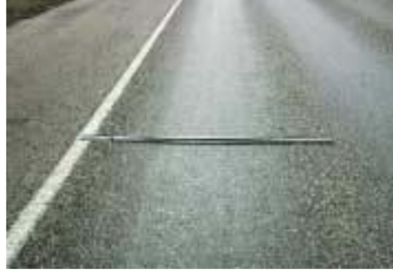
Figura Nª 28: Ahuellamientos, Nivel de severidad (L)
