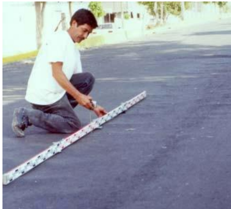
Figura Nª 24: Corrugaciones, Nivel de severidad (M)
