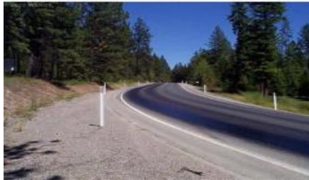
Figura N a 43: Manchas en pavimentos (exudaciones), Nivel de severidad (L)
