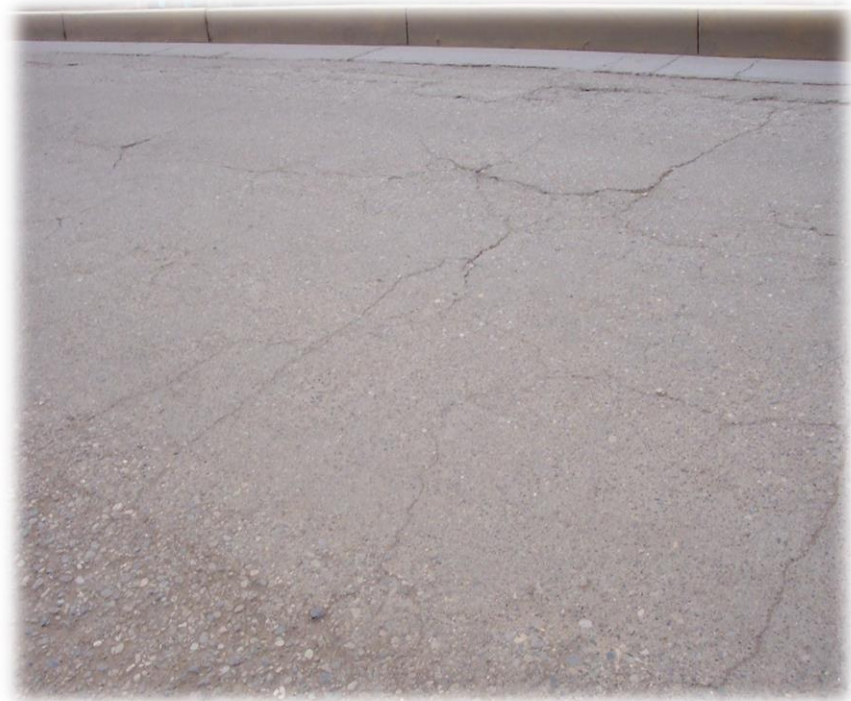
FOTO 04 Grietas transversales en Jr. José Pardo – Cuadra 02
