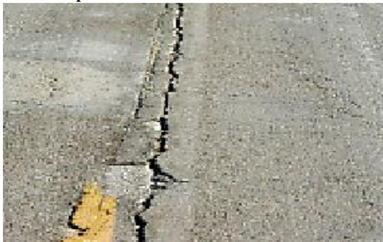
Figura N° 15 Grietas en pavimento
