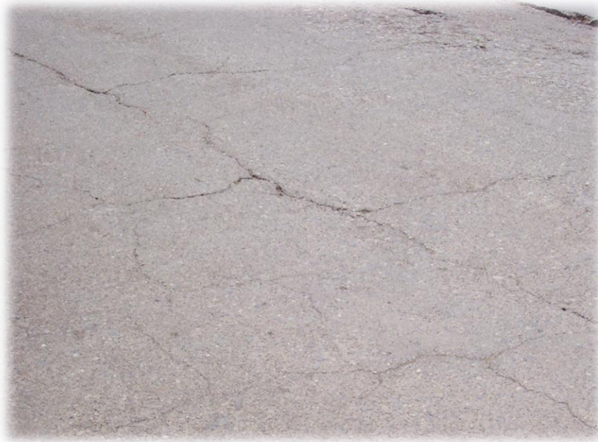
FOTO 03 Grietas longitudinales en Jr. José Pardo – Cuadra 01
