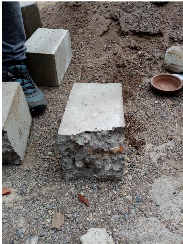
Fotografía 22. Fisura en la vigueta de concreto patrón.
