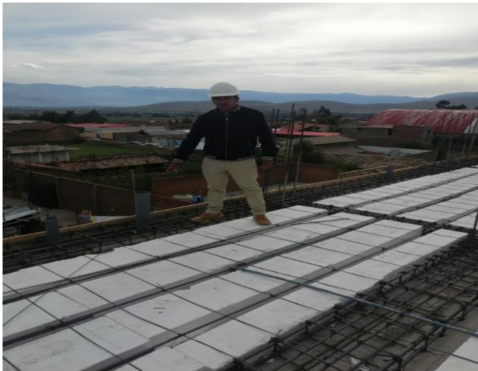
Dos tubos de PVC de \varnothing de 4" cortando una viga chata
