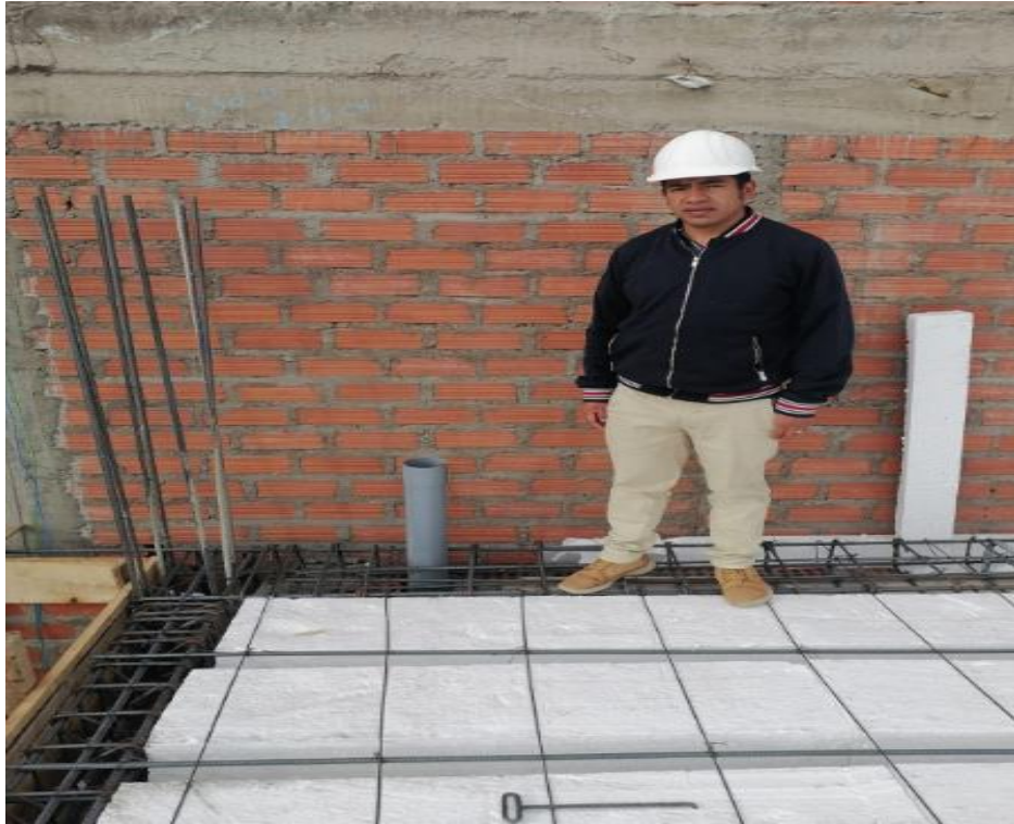
Tubo de PVC de \varnothing de 4" cortando una viga solera
