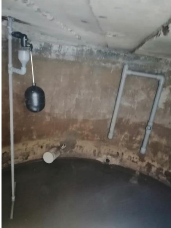
Fotografía 3. Vista de la instalación interna del sistema de cloración por filtros en el caserío El Molino Km 22.
