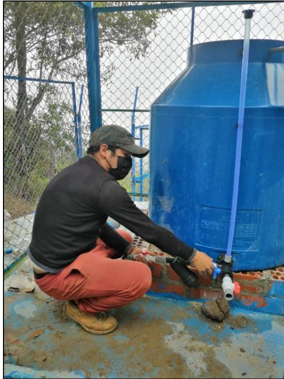
Fotografía 1. Vista de la instalación del sistema de cloración por filtros en el caserío El Molino Km 22.
