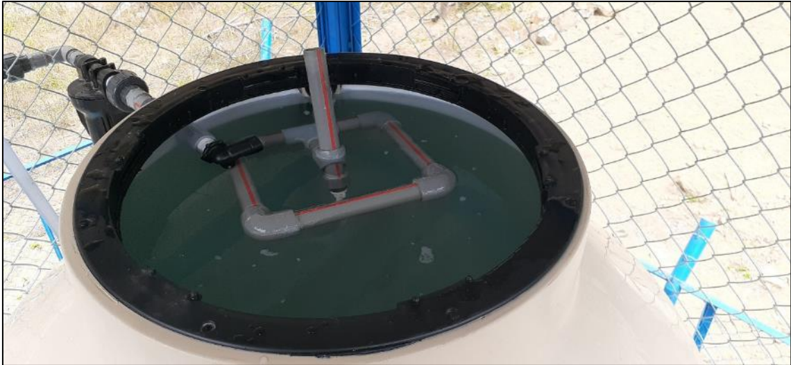
Fotografía 9. Vista del sistema de cloración con flotador con agua en el reservorio del caserío Landa.
