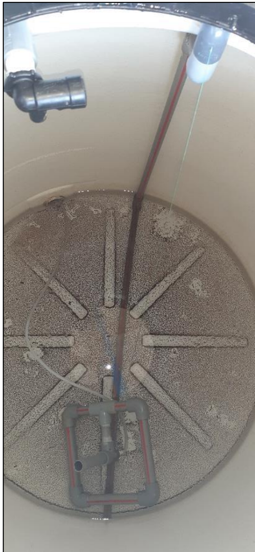
Fotografía 8. Vista del sistema de cloración con flotador en el caserío Landa.
