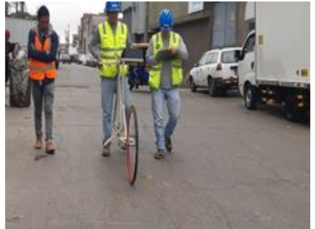
Imagen N° 12. Toma de lecturas de la depresion y la elevacion del pavimento rigido cada 2 metros.
