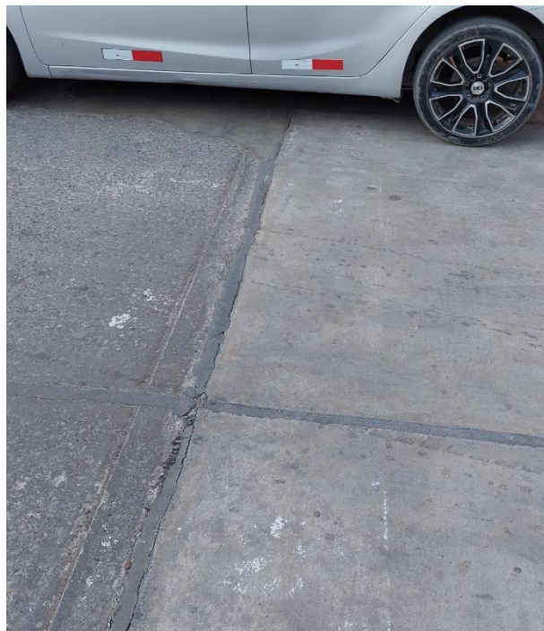
Imagen N° 04. Presencia de parches en el pavimento y fallas en juntas.
