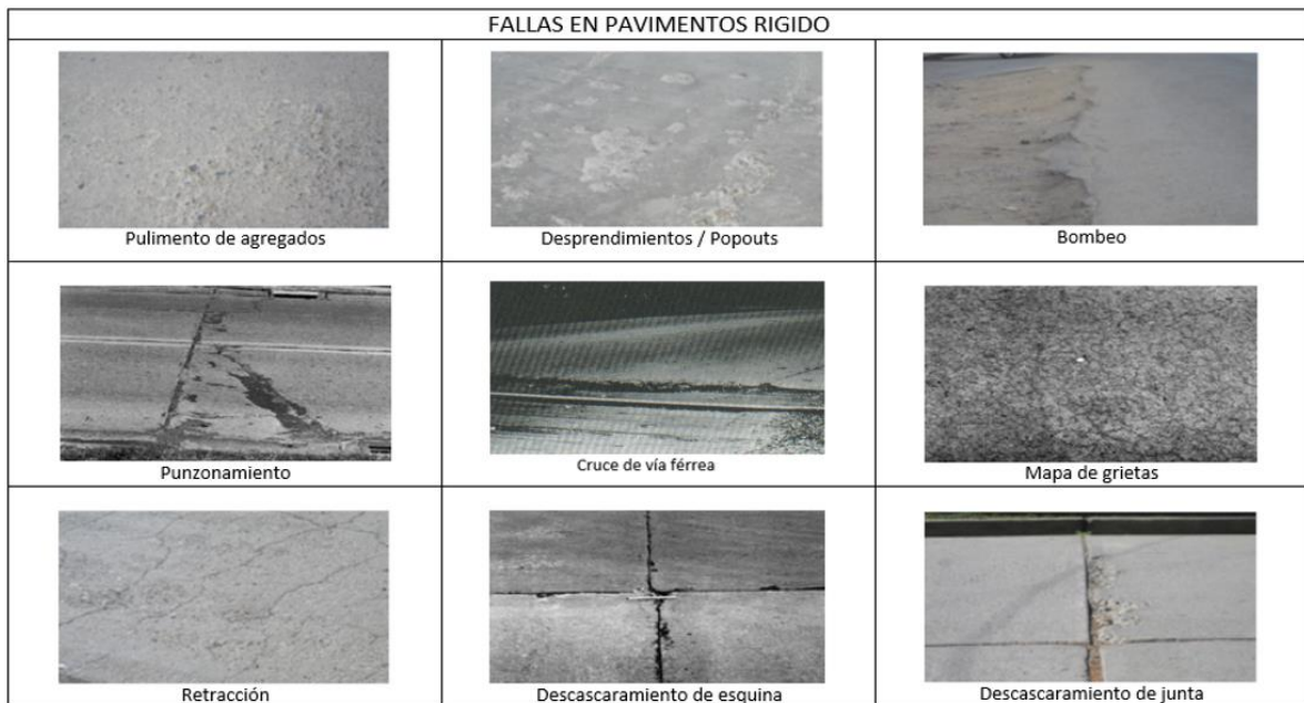
Figura 5 Fallas estructurales del pavimento Fuente de internet
