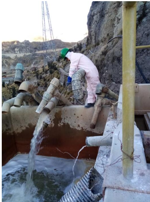
Fotografía 39. Vista de operación de la poza de aguas ácidas.
