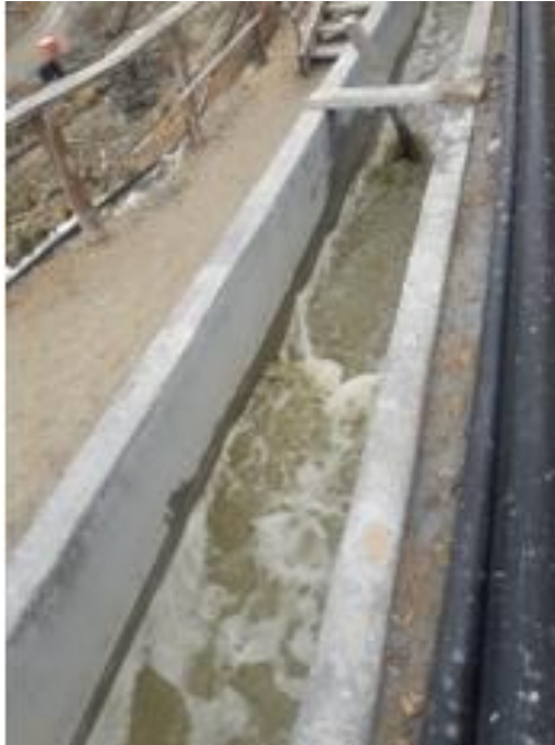
Fotografía 34. Vista del canal en funcionamiento con aguas tratadas.
