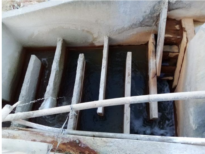
Fotografía 40. Vista de la distribución de reductores de concreto sometidos a las aguas ácidas.
