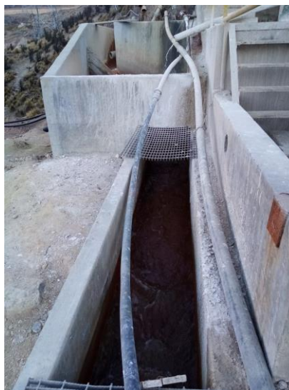
Fotografía 42. Vista del canal de derivación antes de ingreso al pozo de tratamiento de aguas ácidas.
