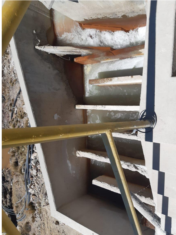
Fotografía 38. Vista en funcionamiento de la poza de tratamiento de aguas ácidas.
