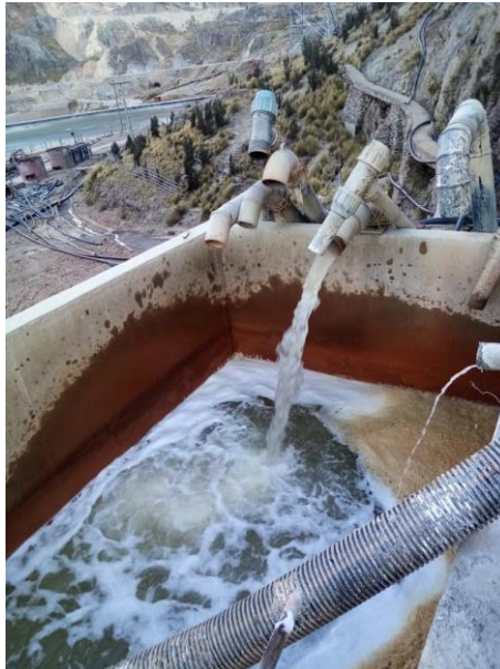
Fotografía 44. Vista del color rojizo, que deja el agua ácida al contacto con la pared de la poza tratada con sikatop seal 107.
