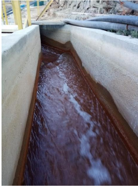
Fotografía 43. Vista de la corrosión originada en la pared de concreto por acción de las aguas ácidas.
