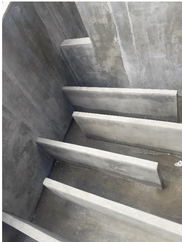
Fotografía 37. Vista en detalle del interior de la poza de tratamiento de aguas ácidas.
