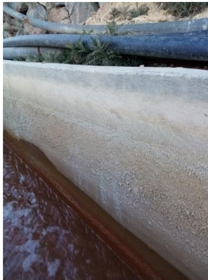
Fotografía 41. Pared del canal de derivación, después de las pozas de control de aguas ácidas.
