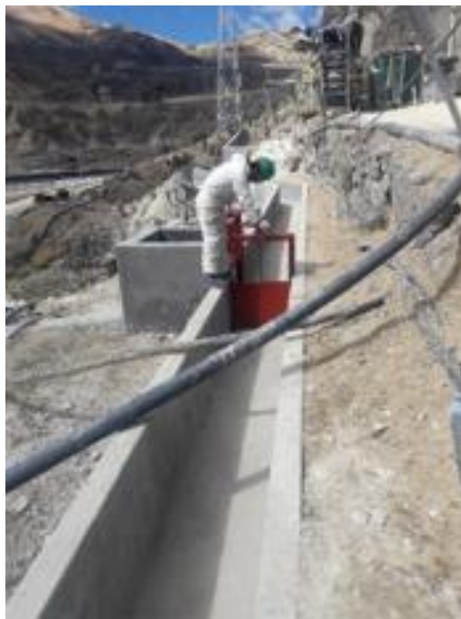
Fotografía 33. Vista del canal de derivación de aguas tratadas.
