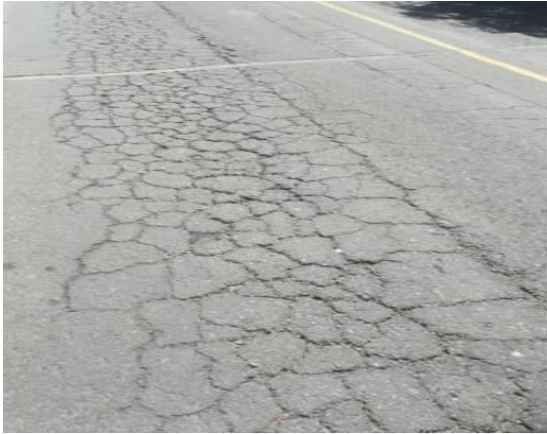
Figura 1. Fallas del pavimento piel de cocodrilo.
