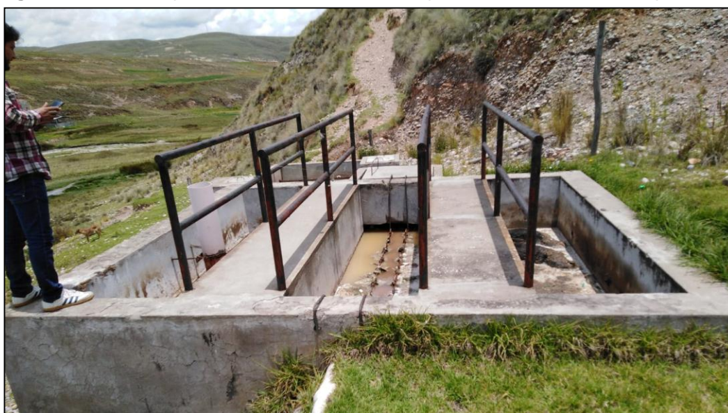
Figura N° 05.- Tanque Imhoff del PTAR de Chaquicocha se encuentra inoperativa.
