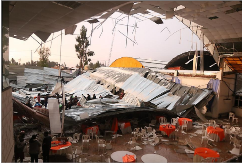
Figura 2: Desplome de cobertura en local en Huancán. Tomada de “La República”.
