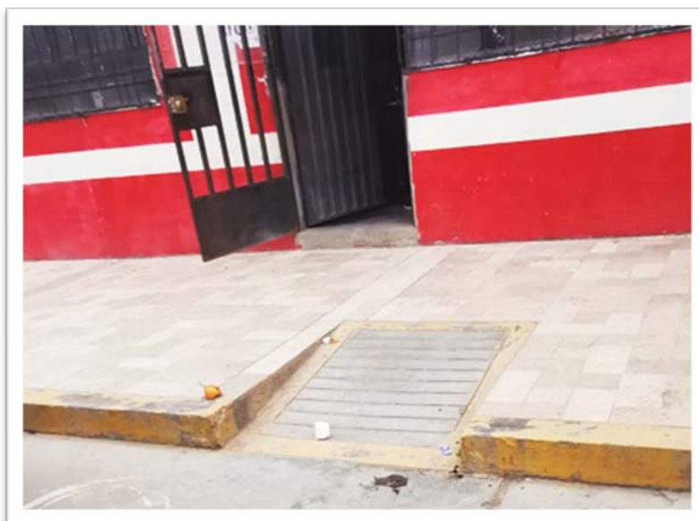
LAS RAMPAS PARA LAS PERSONAS CON DISCAPACIDAD CON LIMITACIONES, Y MAL PROPORCIONADAS.
