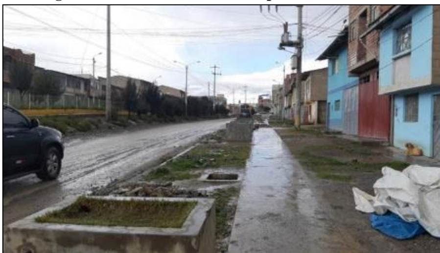
Figura No 01: Deficiencia de la superficie de rodadura.
