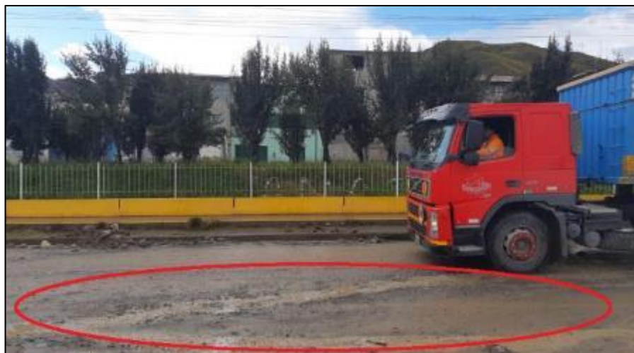
Figura No 02: Evidencia de vehículos pesados y deterioro de la vía.
