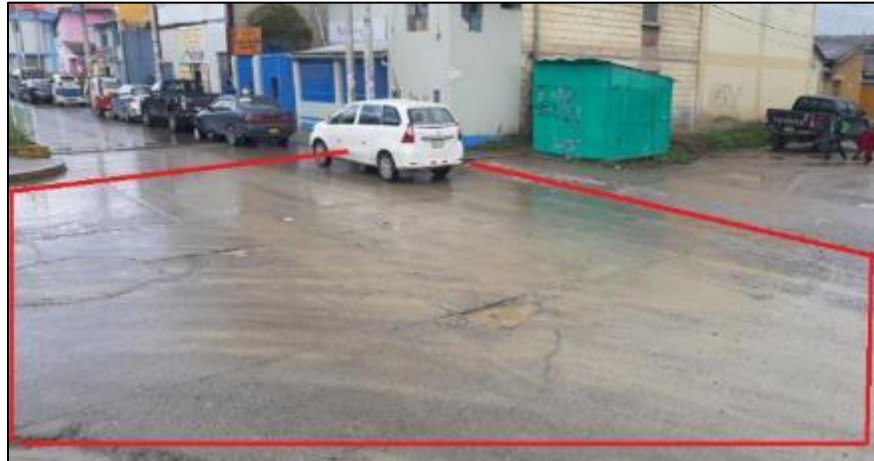
Figura No 05: Pavimento con fisuras.
