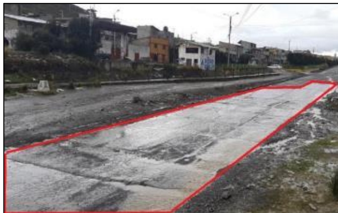
Figura No 04: Evidencia del porcentaje de concreto existente.
