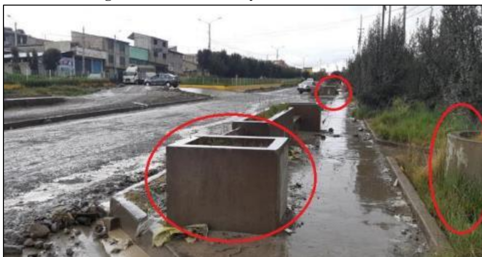
Figura No 11: Veredas y bancas deteriorados.
