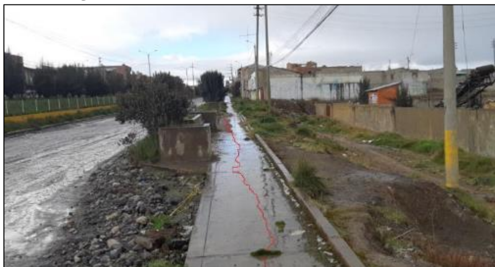
Figura No 10: Veredas con fisuras al costado del MTC.
