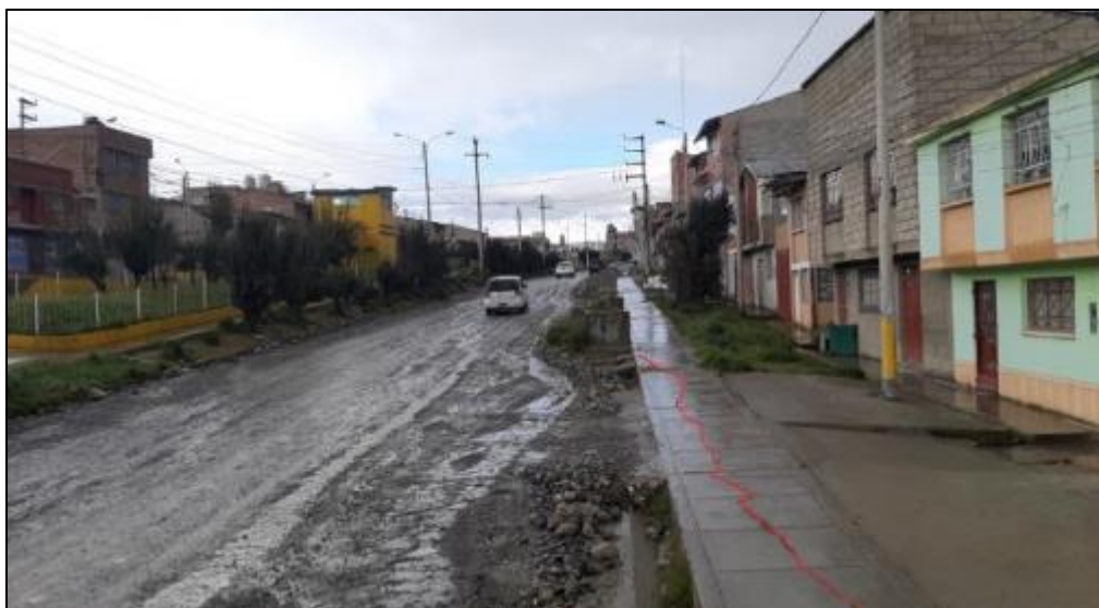
Figura No 09: Veredas con fisuras.
