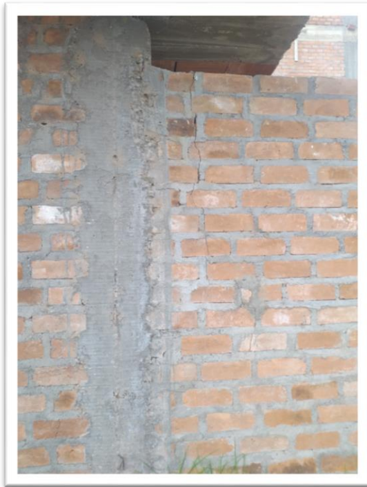
Figura N° 49 Presencia de Grietas en Muro Perimétrico
