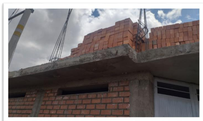
Figura N° 48 Cangrejera en Losa Aligerada
