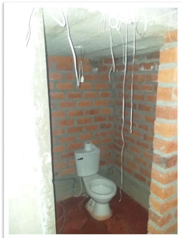
Figura N° 50 SS. HH sin ventilación e iluminación
