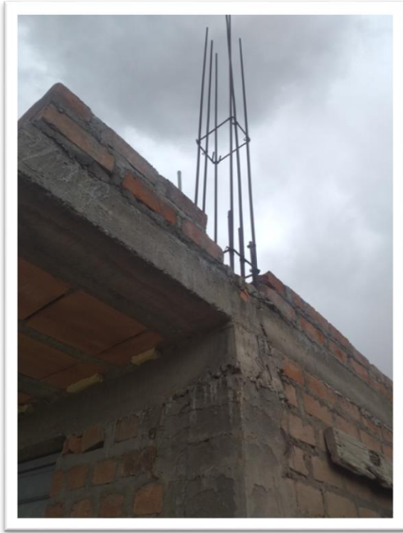
Figura N° 53 Traslape no cumple el mínimo exigido
