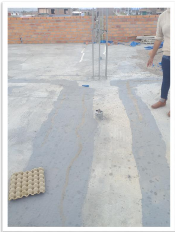
Fuente: Elaboración Propia Figura N° 52 Grieta en Muro Perimétrico
