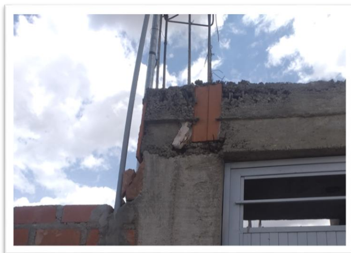
Figura N° 47 Cangrejas en Viga Peraltada
