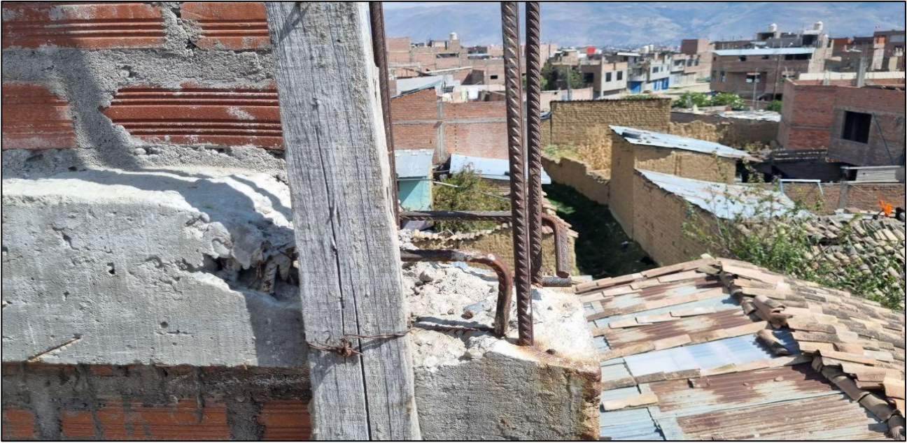
FOTOGRAFÍA 9: Se observa que el encuentro entre la viga solera y la columna no se ha terminado de vaciar por lo que se ocasionara una junta fría.
