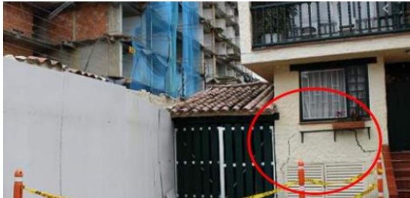
Figura N° 3. Se muestra el comportamiento de la estabilidad (Deficiencia de materiales: Se presentan grietas y fisuras cuando se hacen malas dosificaciones o se usan materiales de mala calidad los cuales afectan a la construcción)
