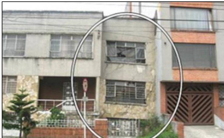
Figura N° 1. Edificio con riesgo muestra una deficiencia constructiva (Deficiencia de diseño: ya que esta no cumple con los requisitos necesarios para su construcción, lo que termina como una deficiencia en el acabado o un desperfecto)
