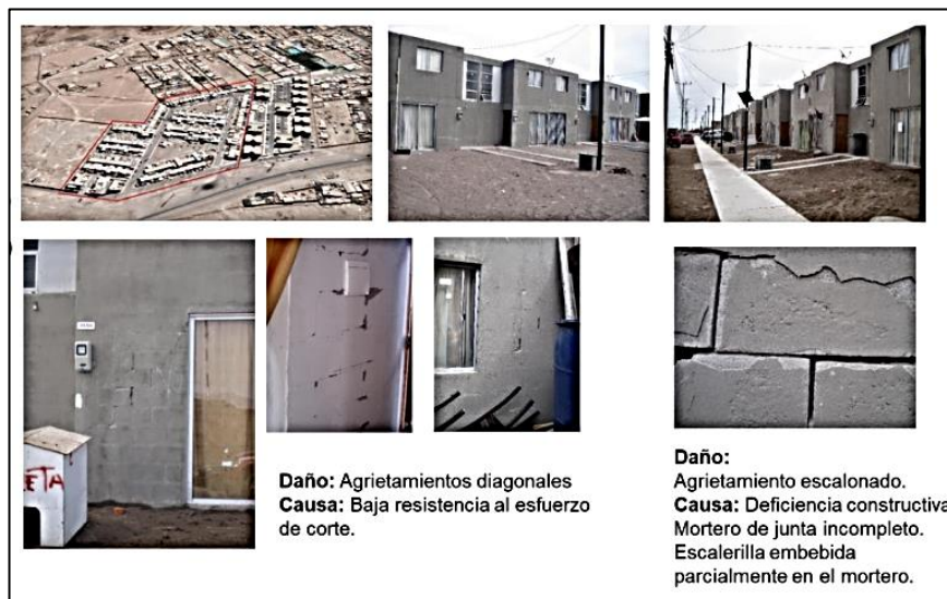
Figura N° 9. Daños encontrados en una edificación de albañilería (Se presentan grietas diagonales en las construcciones a causa de la deficiencia constructiva y el mortero de las juntas incompletas)
