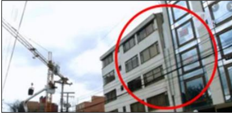
Figura N° 2. Inclinación de la estructura que muestra una deficiencia en el proceso de construcción y un efecto de asentamiento (Deficiencia en los cimientos: Este se presenta por que no existe un cimiento estable en el área donde se construyó)
