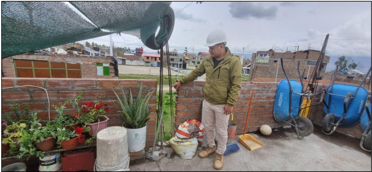
Fotografía 3: Se observa que el acero corrugado de \frac{1}{2} " f_y=2400\text{kg/cm}^2 , se encuentra oxidado y no tiene el mantenimiento debido para que se pueda construir posteriormente.
