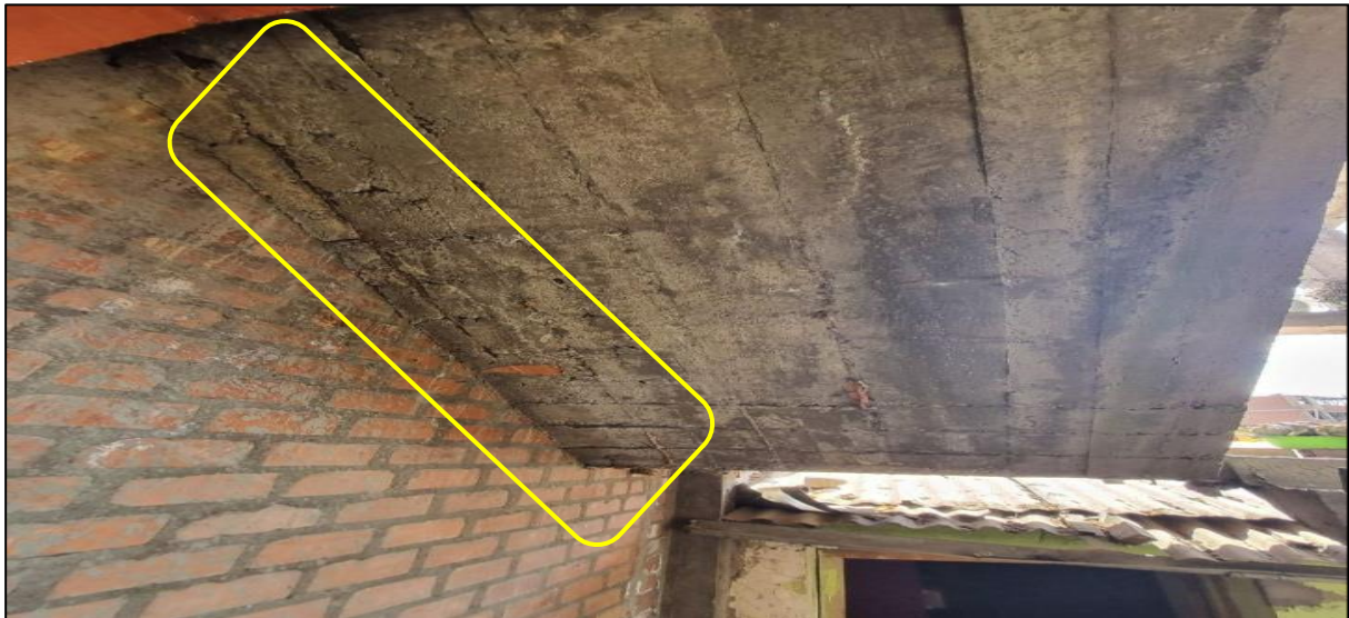
FOTOGRAFÍA 6: Se verifica que el acero corrugado de \frac{1}{2} " f_y=2400\text{kg/cm}^2 en la parte longitudinal y transversal de la escalera, no tiene recubrimiento necesario por lo cual está a la intemperie.
