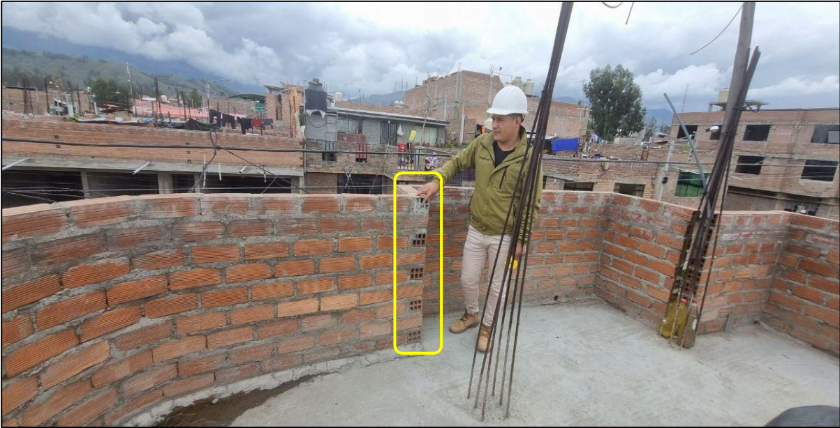
FOTOGRAFÍA 1: Se observa que la vivienda está utilizando ladrillo pandereta lo cual no está permitido por la norma E-070.
