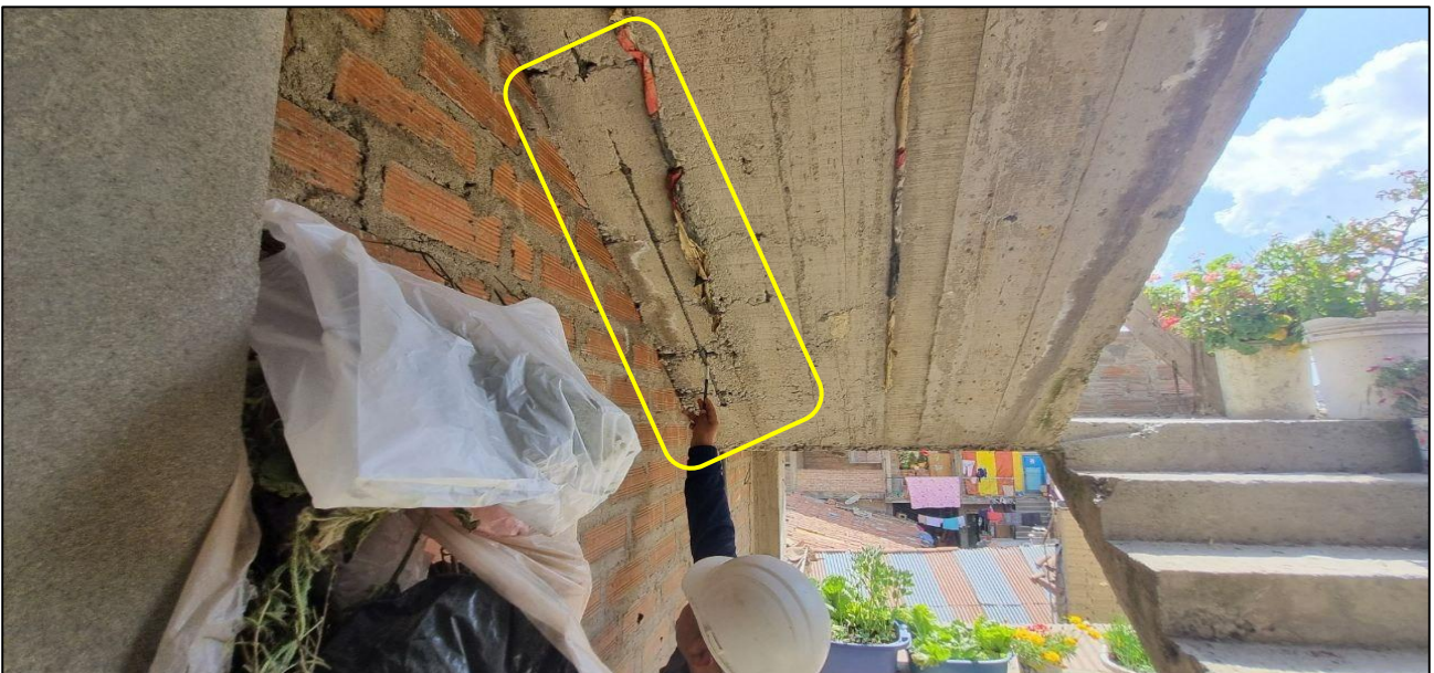
FOTOGRAFÍA 8: Se verifica que el acero corrugado de \frac{1}{2} " f_y=2400\text{kg/cm}^2 en la longitudinal en la escalera, no tiene recubrimiento necesario y de a misma manera se observa restos de papel de cemento.
