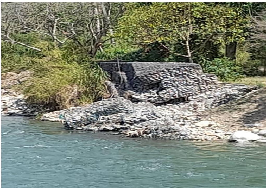
“Fotografía 2. “Vista de la faja marginal margen izquierda rio tulumayo se “observa muro de gaviones colapsado por las inundaciones”
