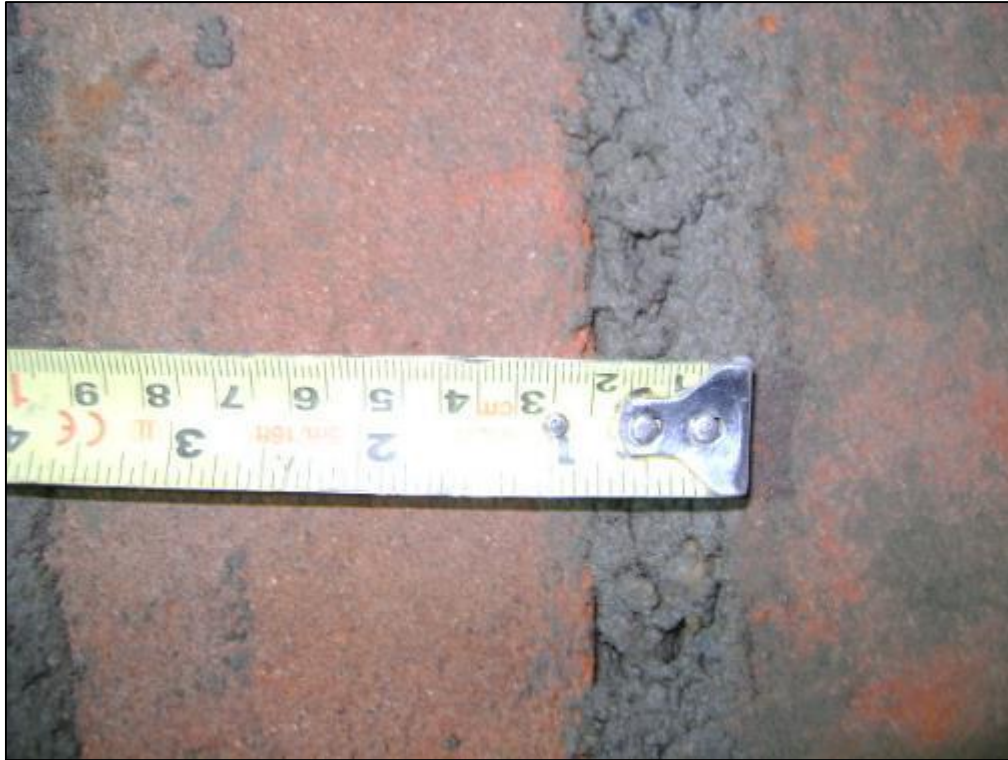
Fotografía 13. Vista de junta de 2 cm de espesor.
