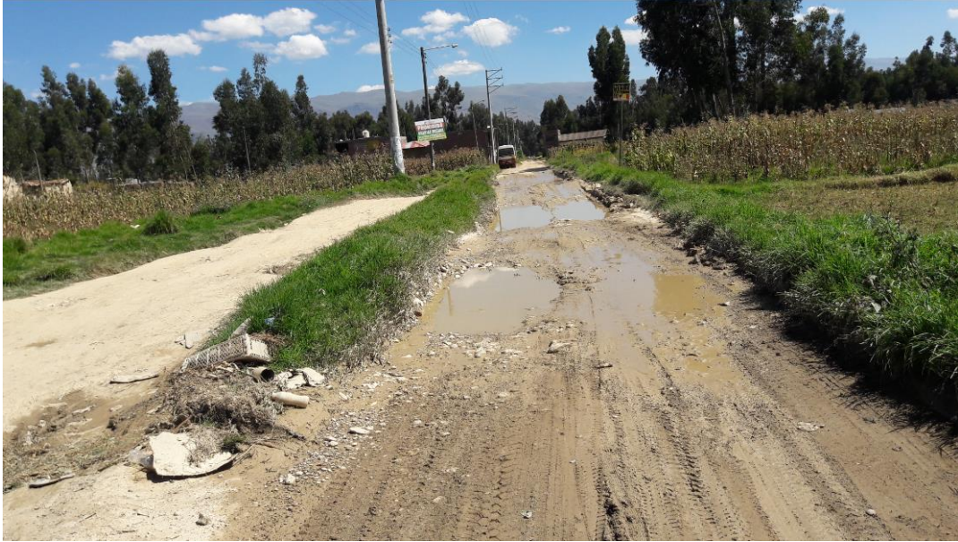
Imagen 01: Vista de baches en la Av. Alfonso Ugarte- cuadra 03
