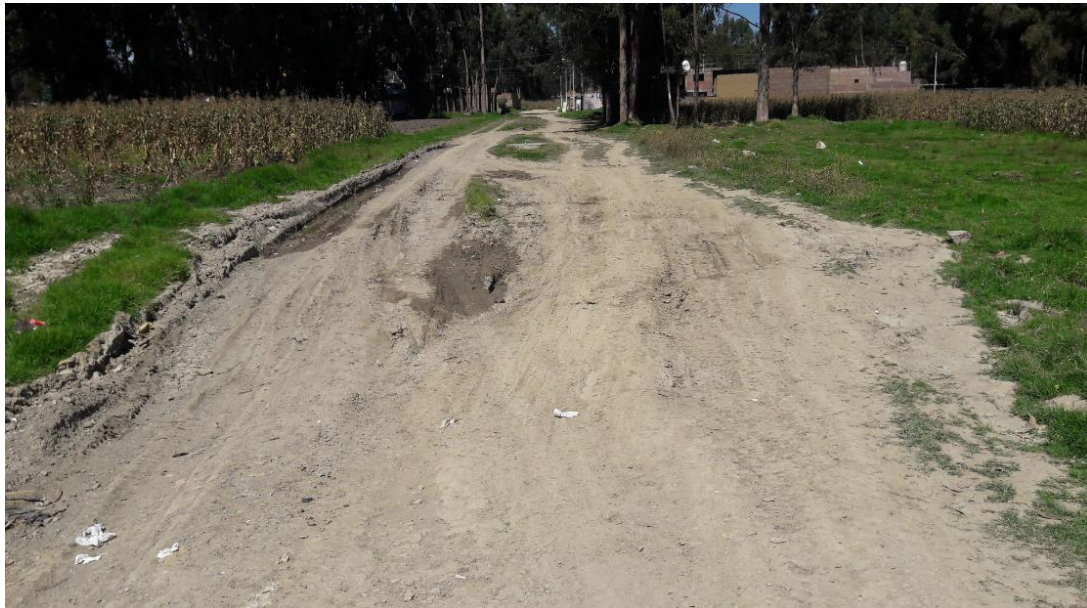
Imagen 05: Vista de bache en la Av. 31 de Octubre - cuadra 06
