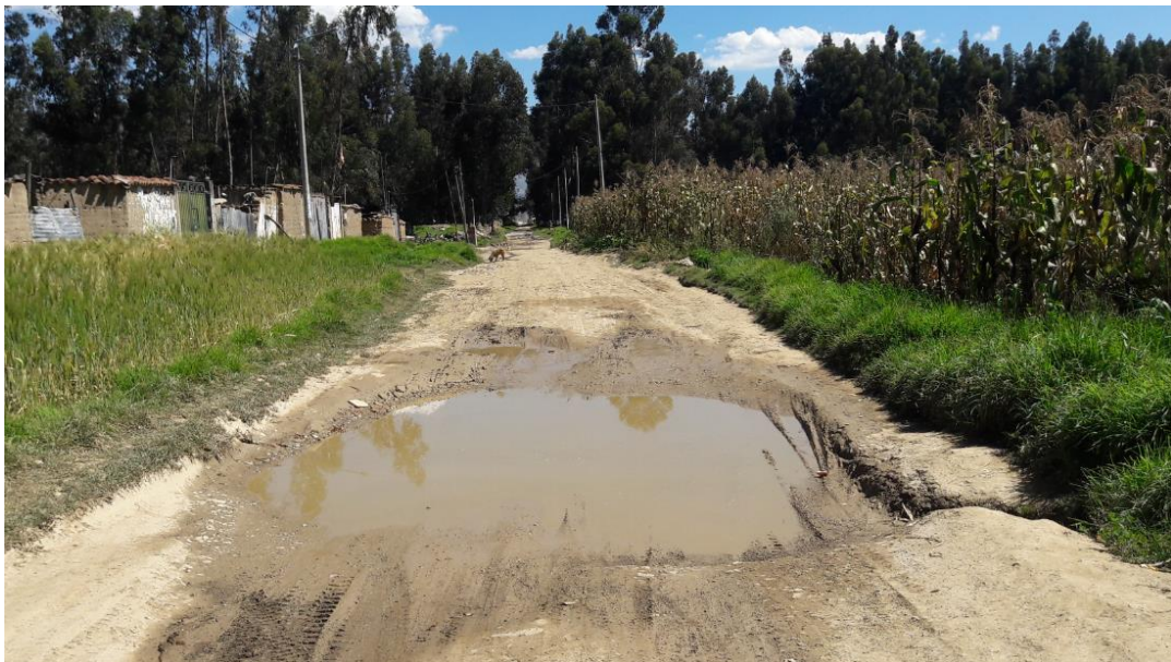
Imagen 02: vista de bache en la Av. Alfonso Ugarte- cuadra 04
