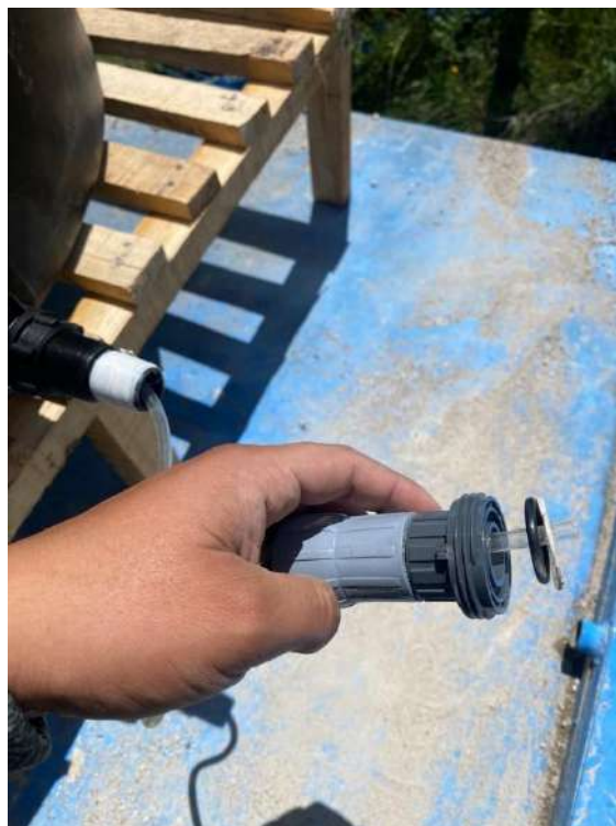
En la décimo segunda fotografía, se muestra uno de los principales componentes del sistema de cloración por goteo.
