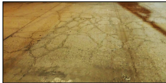
Figura 1.2: Falla en Pavimento Rígido
