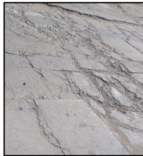
Figura 1.1: Falla en pavimento rígido
