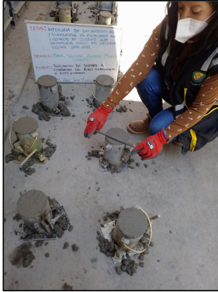
Figura 38: Elaboración de testigos cilíndricos con adición de los aditivos 0.40% de viscocrete 50 HEPE y 0.42% sikament 290N, según referencia de la norma NTP 339.034 / ASTM C39.
