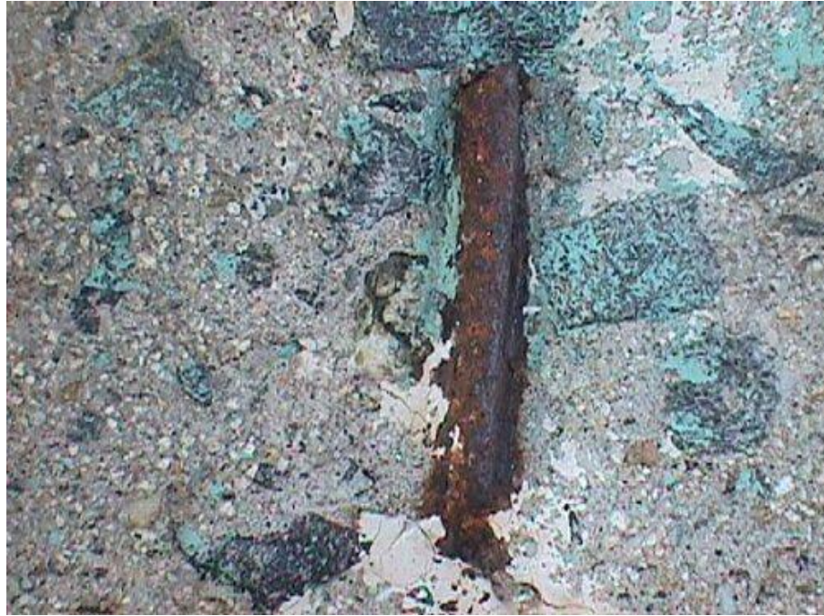
Figura 3 Se observa la corrosión del acero en el concreto armado Fuente: ISO 8044:2020, Corrosión de metales y aleaciones.
