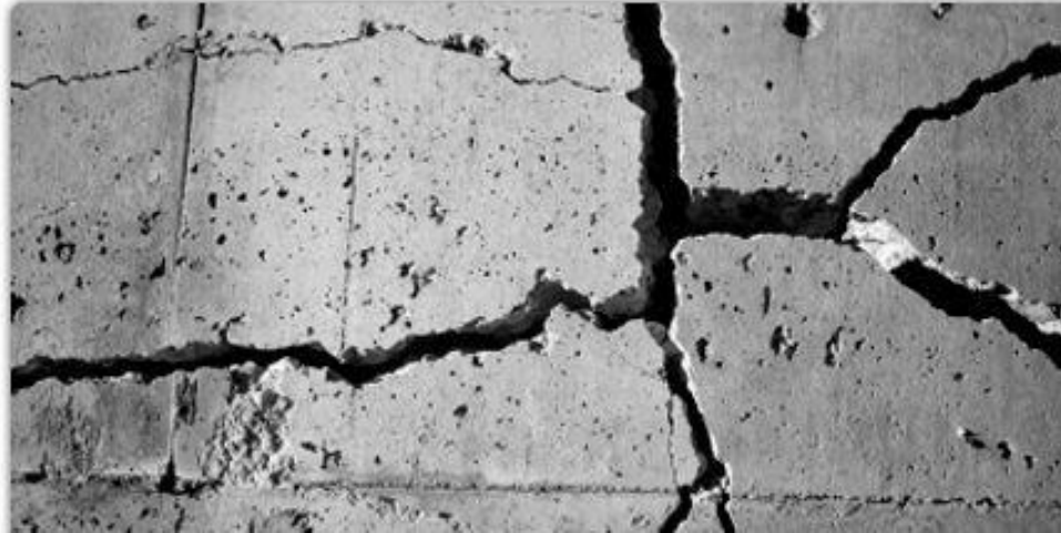
Figura 4 Se observa patologías de concreto, en este caso fisuración del concreto
