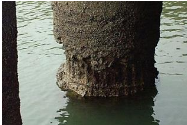
Figura 1 Desgaste del concreto debido a condiciones ambientales y vida útil del elemento estructural. Fuente propia
